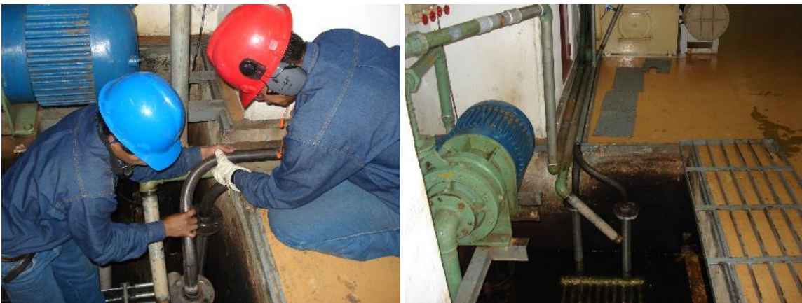
Fotografía 5, Implementación de tuberías y llaves de aislamiento
