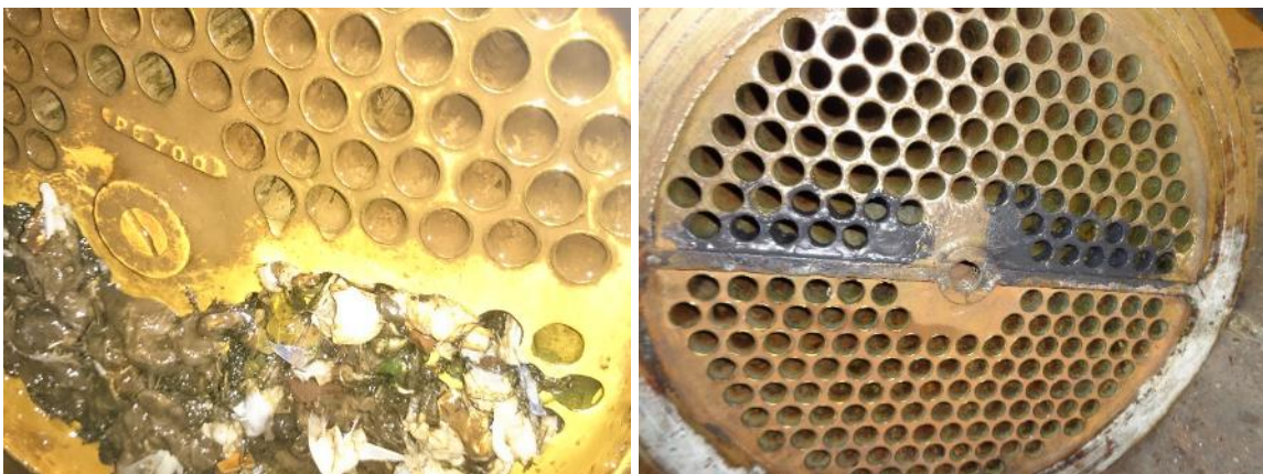
Fotografía 2.4: Obstrucción y deterioro del cabezal, intercambiador coraza-tubo
