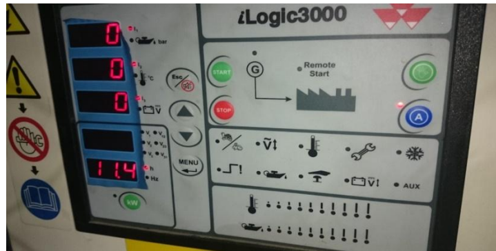
Figura 2. 49 Panel de control del grupo generador
