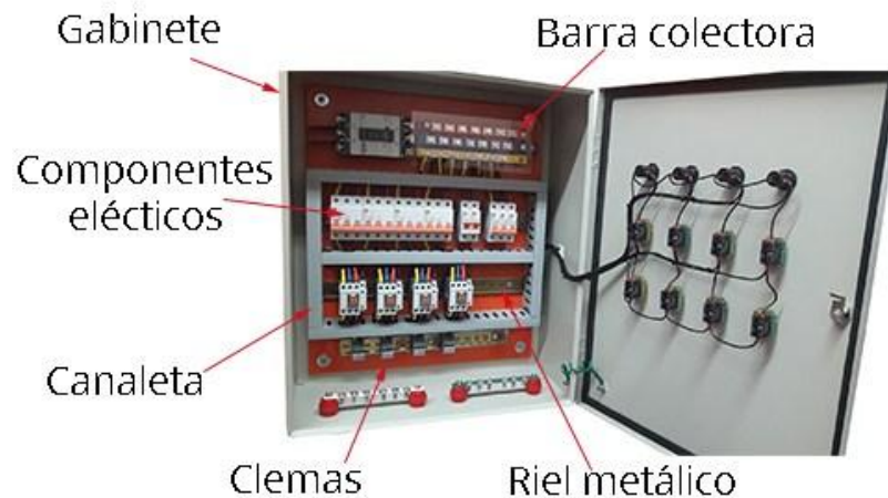
Figura 2. 33 Tablero eléctrico en el centro de datos
