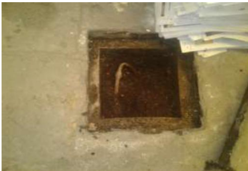
Figura 2. 64 Cámara donde se ubicara puesta a tierra
