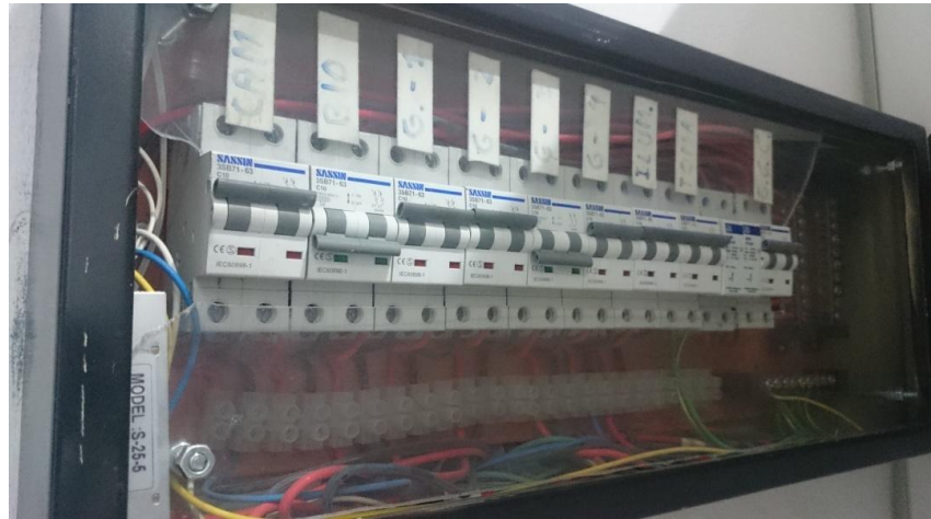
Figura 2. 44 Tablero para la sala de Telecomunicaciones con el cableado terminado
