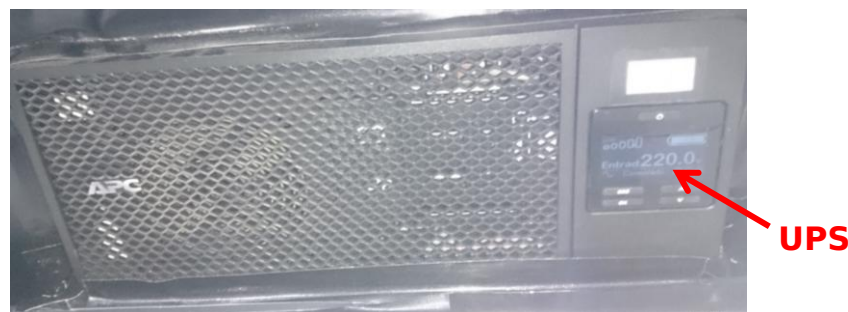
Figura 2. 58 Sistema de Energía Ininterrumpida en funcionamiento
