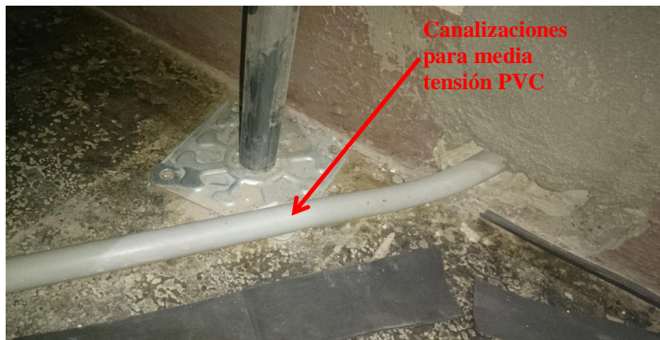
Figura 2. 26 Canalizaciones de PVC en el interior del centro de datos
