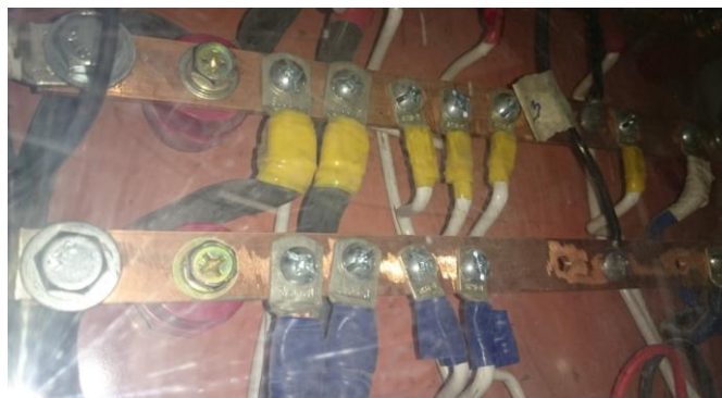
Figura 2. 45 Barras sólidas de cobre para la puesta a tierra
