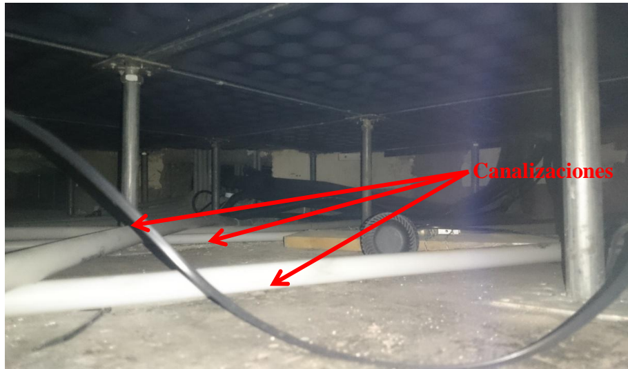
Figura 2. 24 Canalizaciones en la parte inferior del piso técnico
