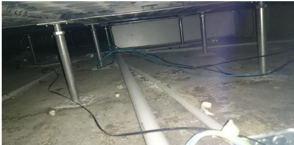
Cableados en el interior del CPD
