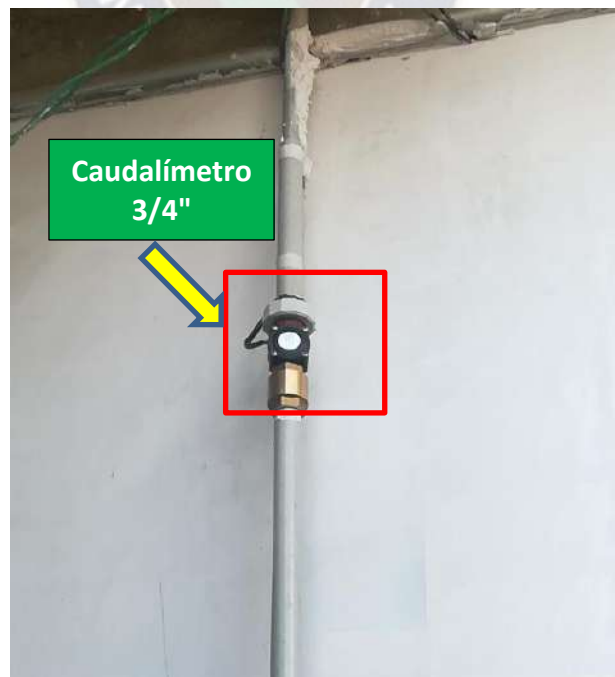
Figura N°89. Caudalímetro de 3/4" instalado en tubería Fuente: Elaboración propia
