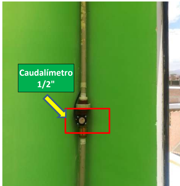
Figura N°86. Caudalímetro de 1/2" instalado en tubería Fuente: Elaboración propia
