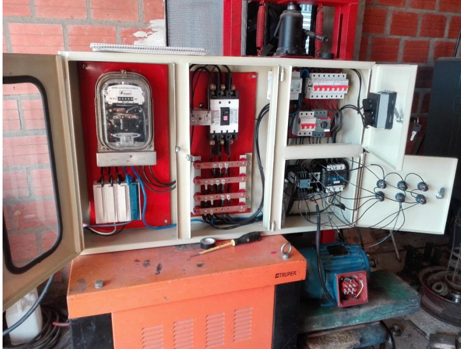
Ilustración 14 Tablero de Aplicación de Banco de Condensadores
