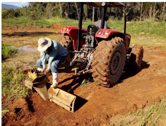
Figura 19: Eliminación de lodo y materia orgánica en descomposición con la ayuda de un tractor agrícola.
