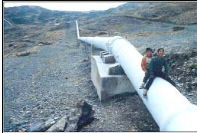
Figura 25: Tuberías de Transporte de Caudal de agua de la represa de Hampaturi hacia la Potabilizadora de Pampahasi
