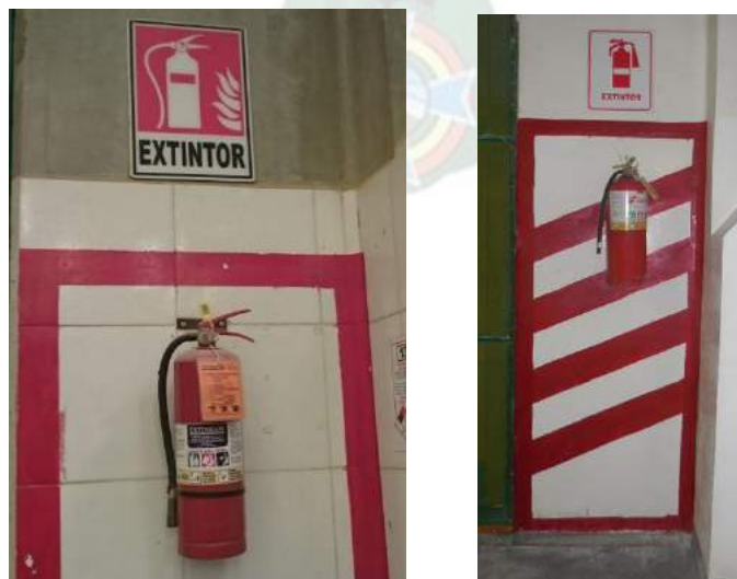
FIGURA 5-25. Señalización y presentación de los extintores portátiles en Irupana S.A.
