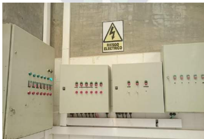
FIGURA 5-11. Tableros eléctricos en la planta de producción de Irupana S.A.
