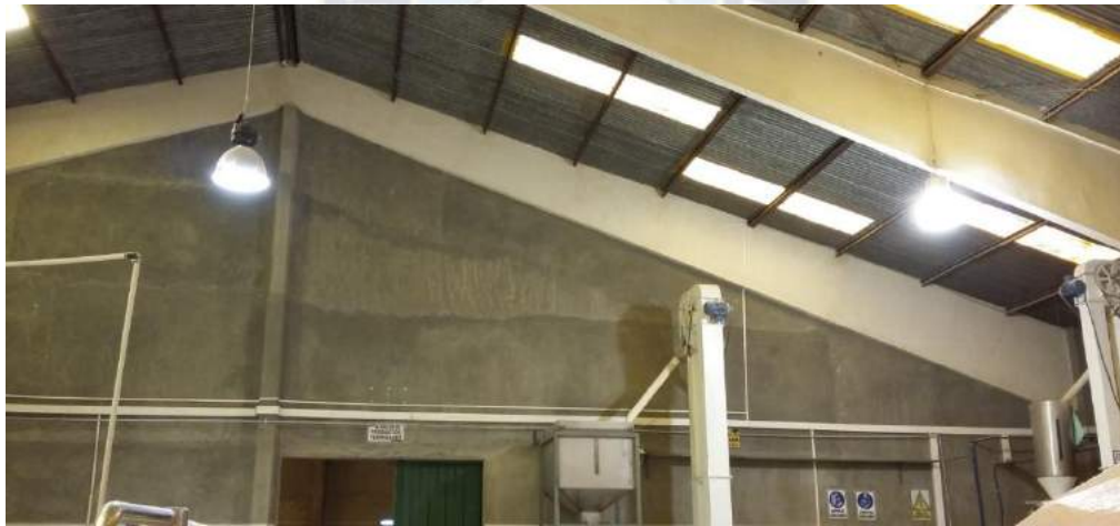
FIGURA 5-4. Iluminación en la planta de producción de la empresa Irupana S.A.
