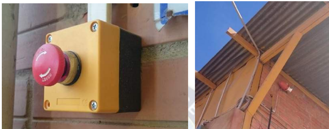
FIGURA 5-19. Botón de emergencia y bocina de alarma en Irupana S.A.
