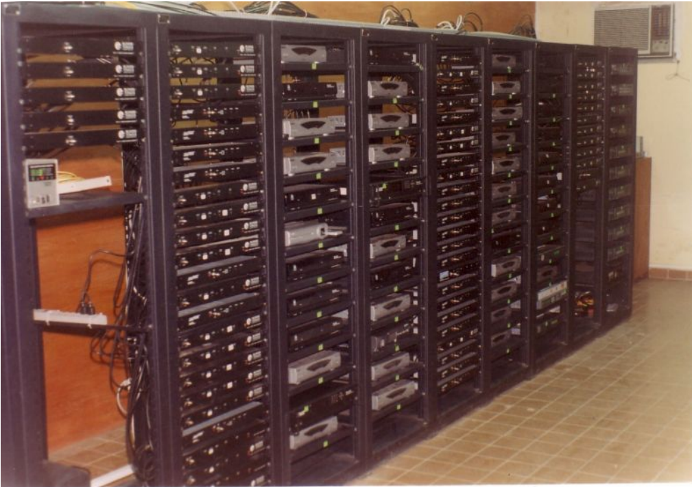
Figura 15 Instalación de la Cabecera de CATV
