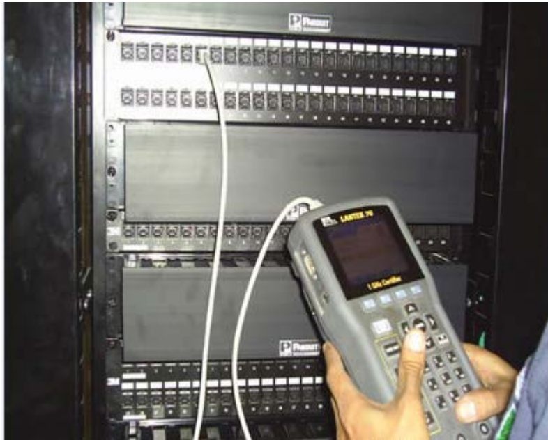
Fig. 4.10 Certificación de cableado
