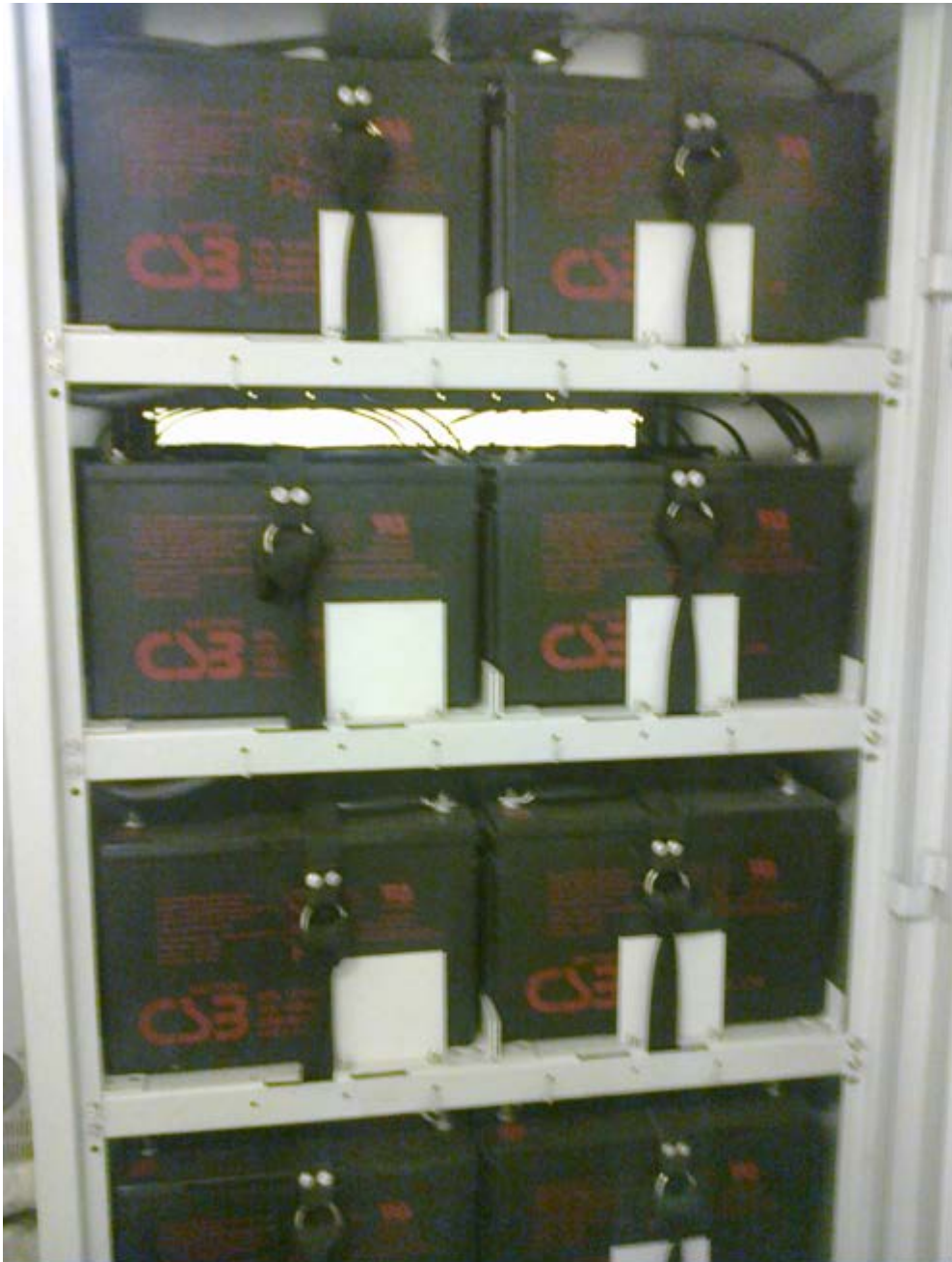
Banco de baterías UPS Borri 4000
