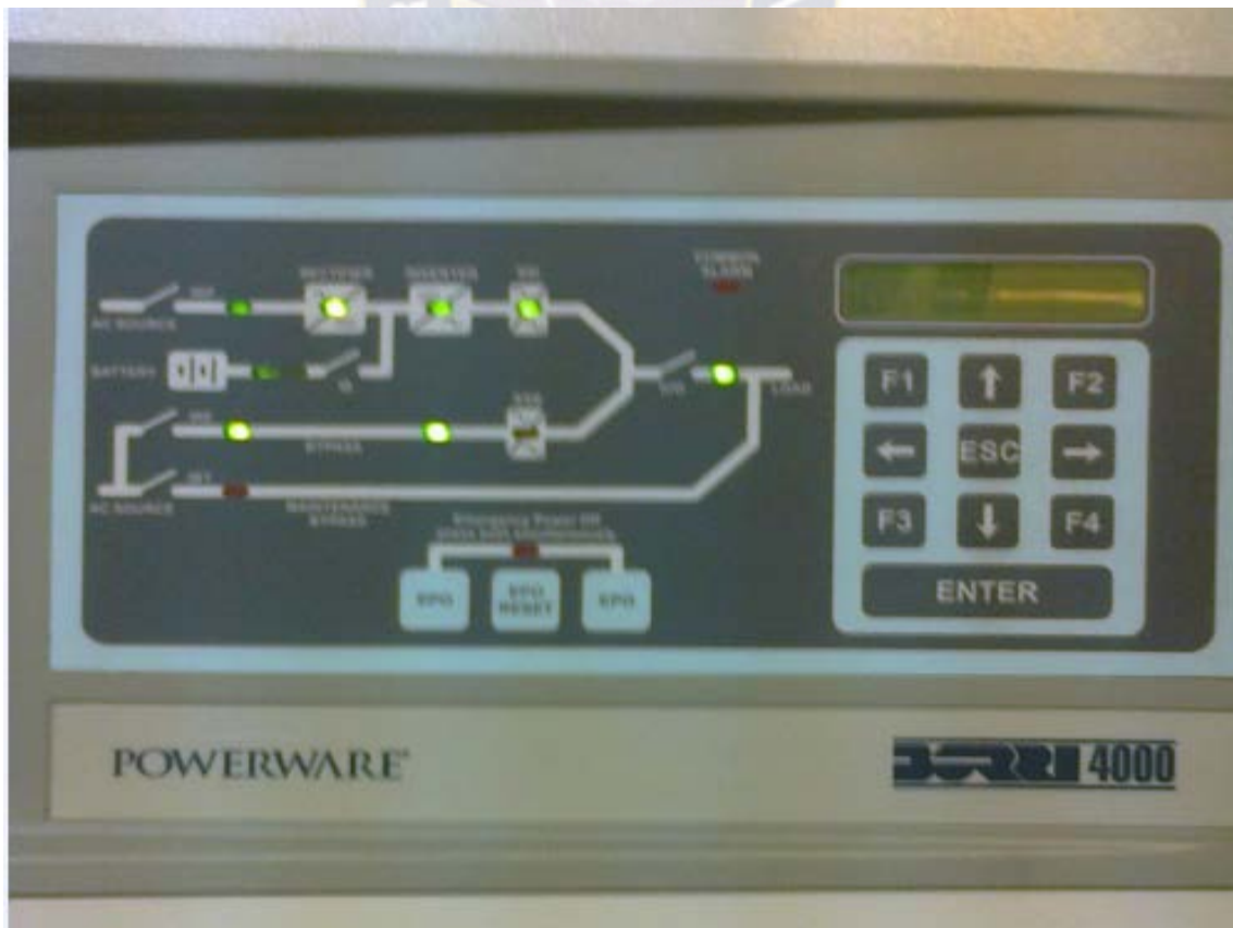
Consola de control ASFI
