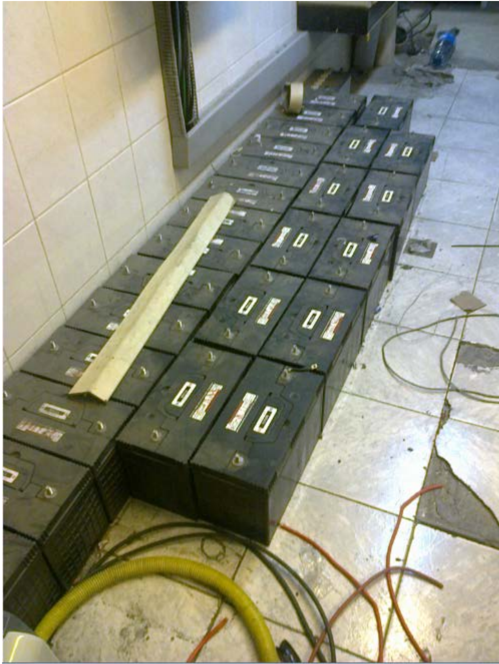
Baterias de ASFI dañadas por uso
