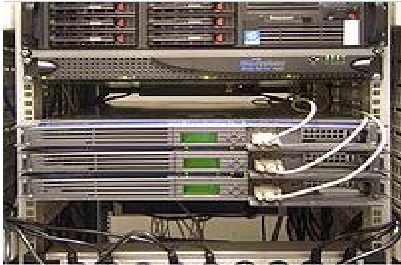
Fig. 2.01 Rack de Equipos 1
