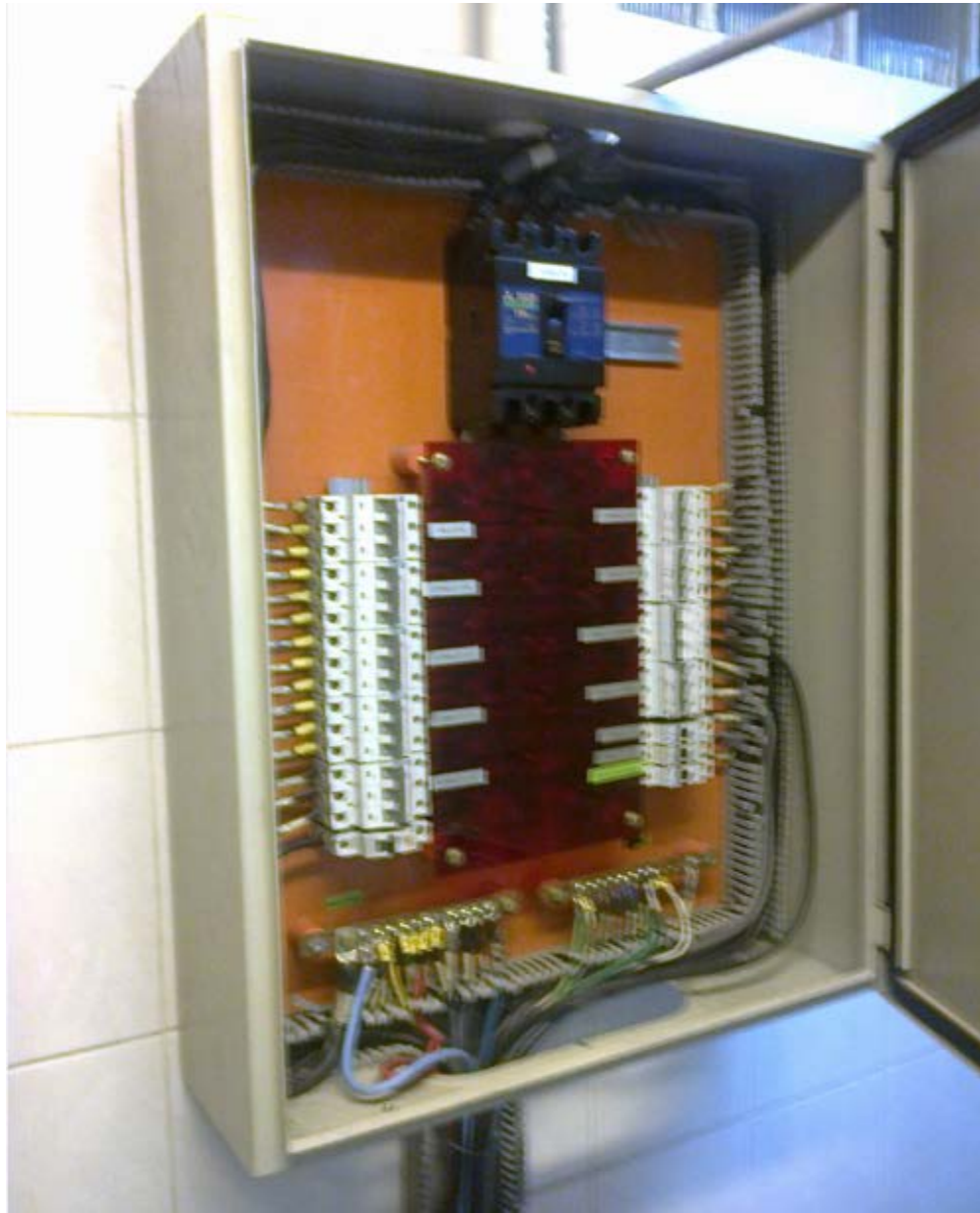
Panel de distribución principal de ASFI energía regulada
