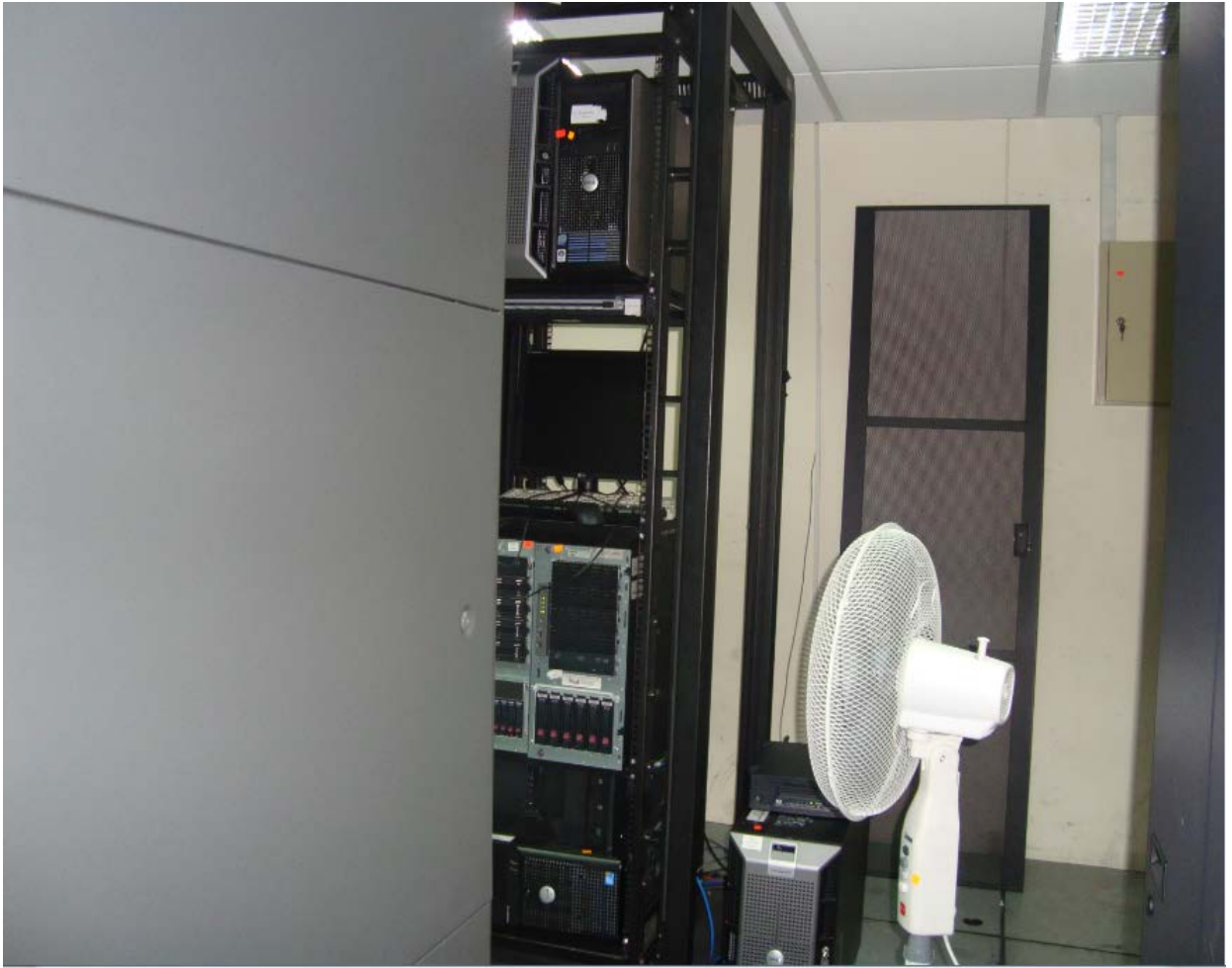
Fig. 4.08 Rack de ASFI sin puertas
