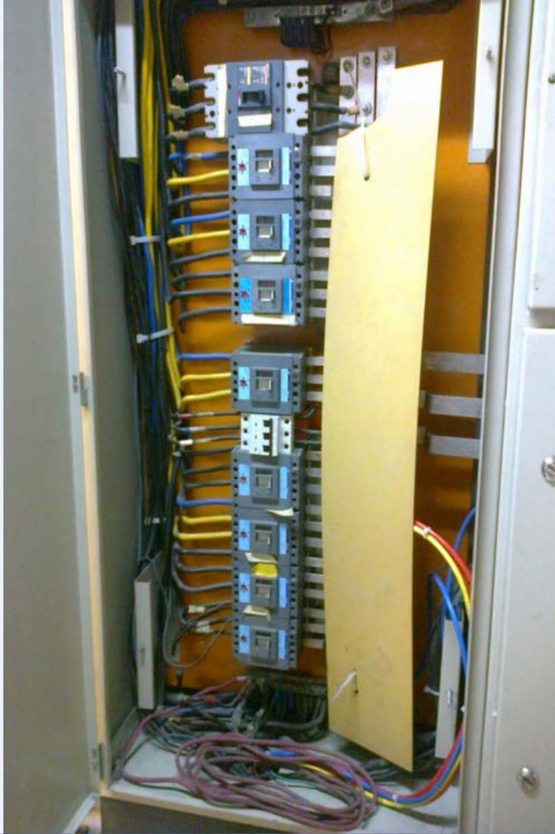
Panel de distribución energía no regulada
