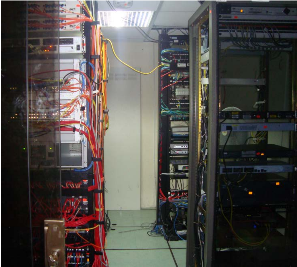
Fig. 4.09 Cableado de ASFI
