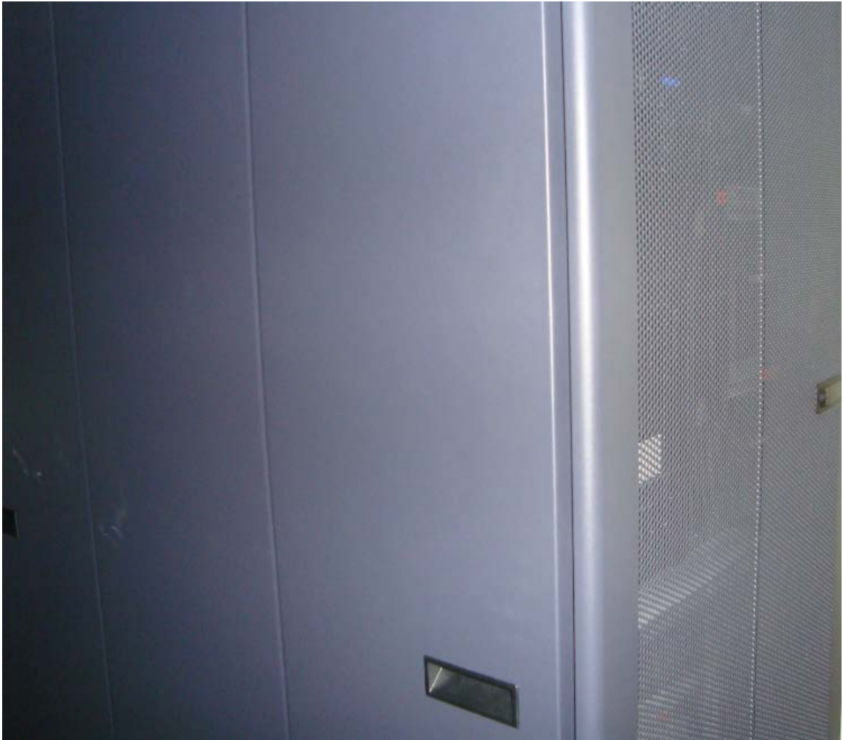
Fig. 4.07 Rack de ASFI perforado al 60%
