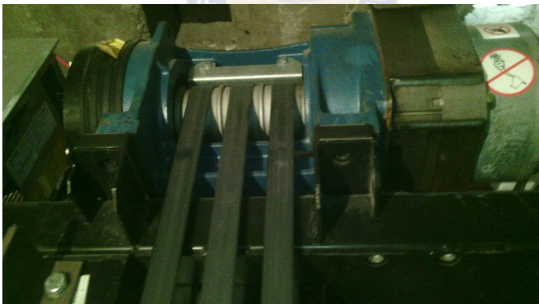
Fotografía 14.- Cintas de Tracción
