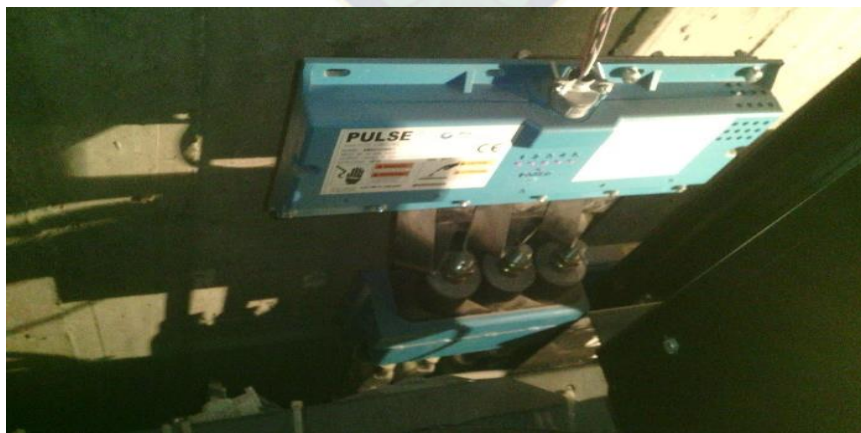
Figura 19.- Sistema de Monitoreo a las cintas de tracción.
