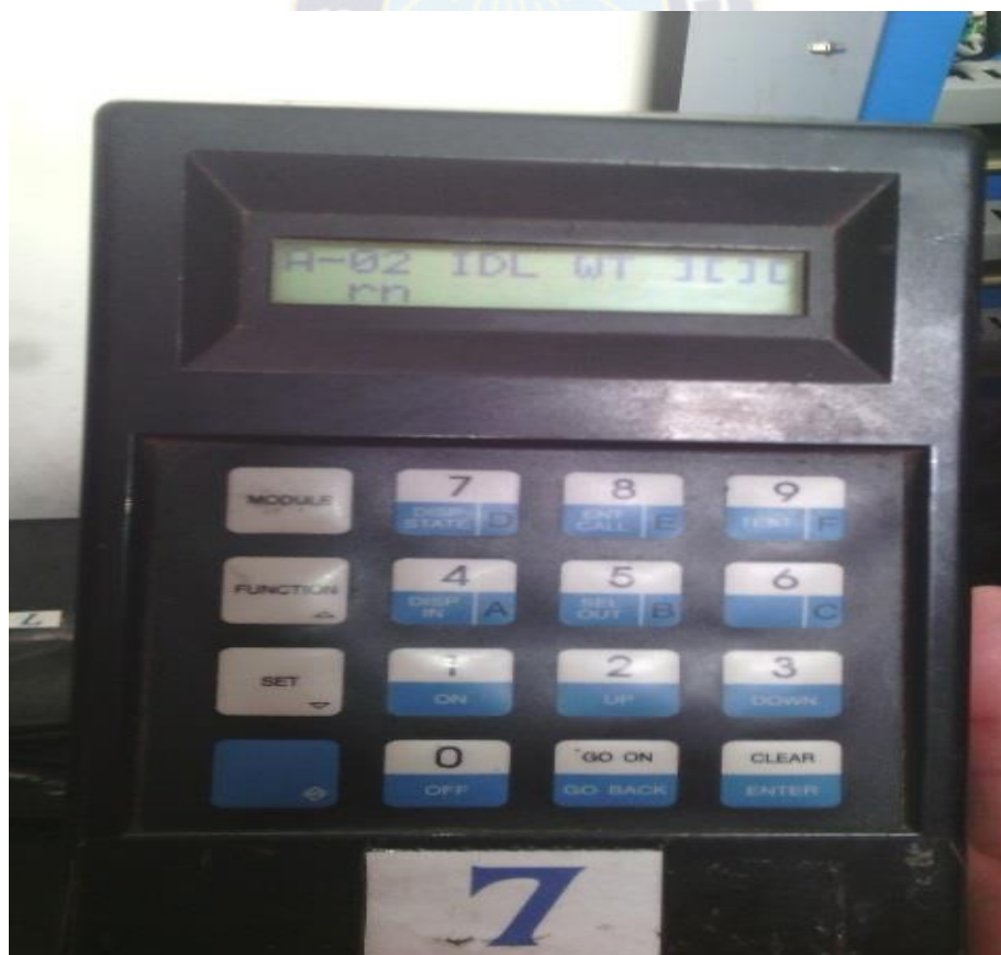
Figura 13.- Unidad Remota de Monitoreo (URM)
