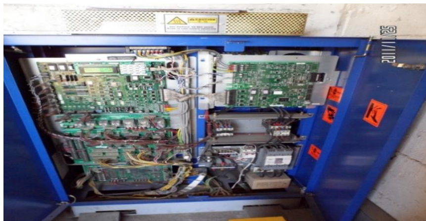
Figura 18.- Panel de Control
