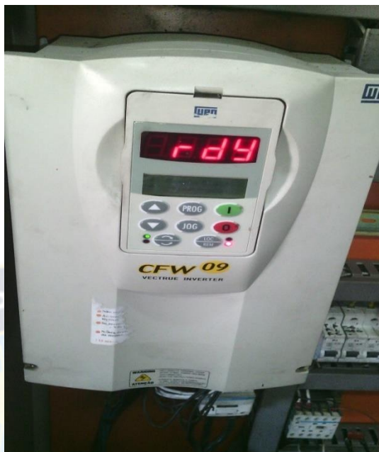
Fotografía 13.- Variador de frecuencia
