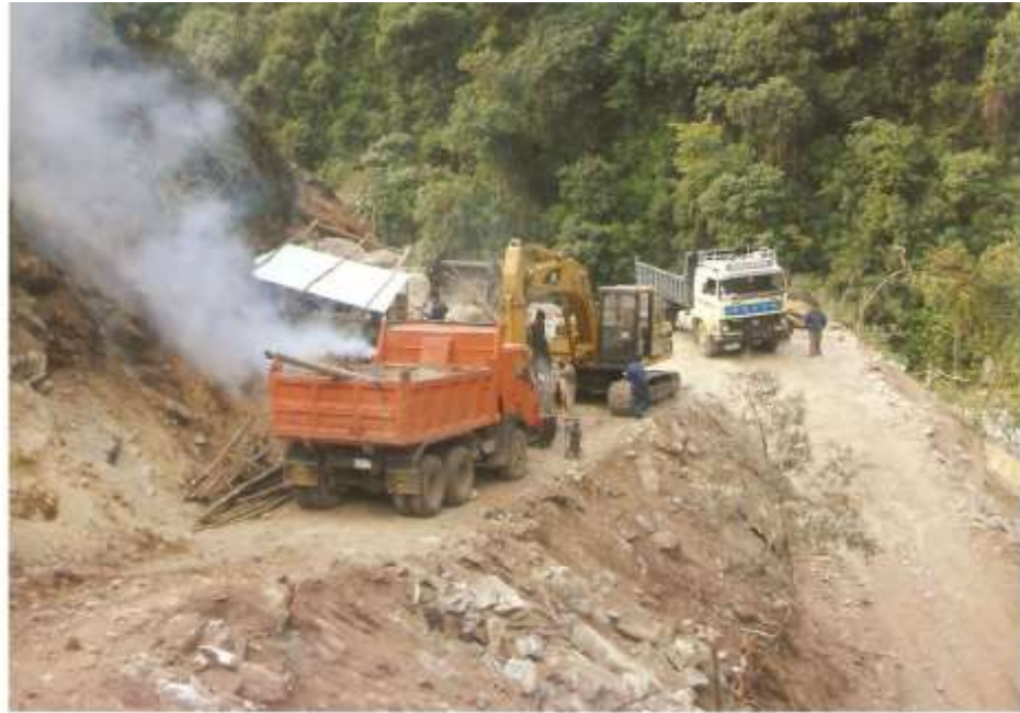
Fotografía No.5 Destrozo del Río Chijchinbaya Tacacoma Sector IV
