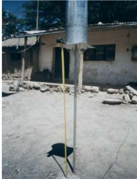
Fotografía 5. Instalación del pluviómetro
