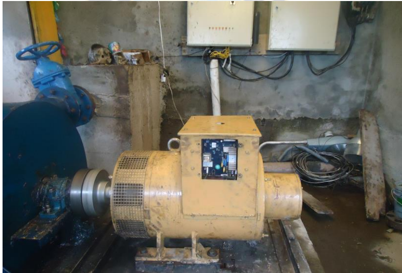
Fig. 4.10 Generador eléctrico (30 Kw) Fuente: Fotografía (Agua Blanca)
