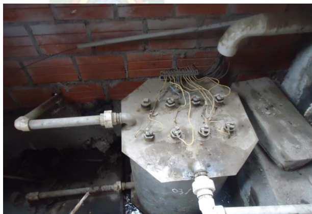
Fig. 4.14 Banco de resistencias (balastro) Fuente: Fotografía (Yanamayo)
