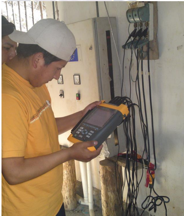
Foto: Mantenimiento con analizador eléctrico avanzado Fluke 434 (Santa Rosa de Quilo Quilo)
