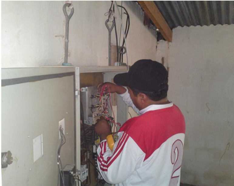
Foto: Mantenimiento del controlador de carga (Santa Rosa de Quilo Quilo)
