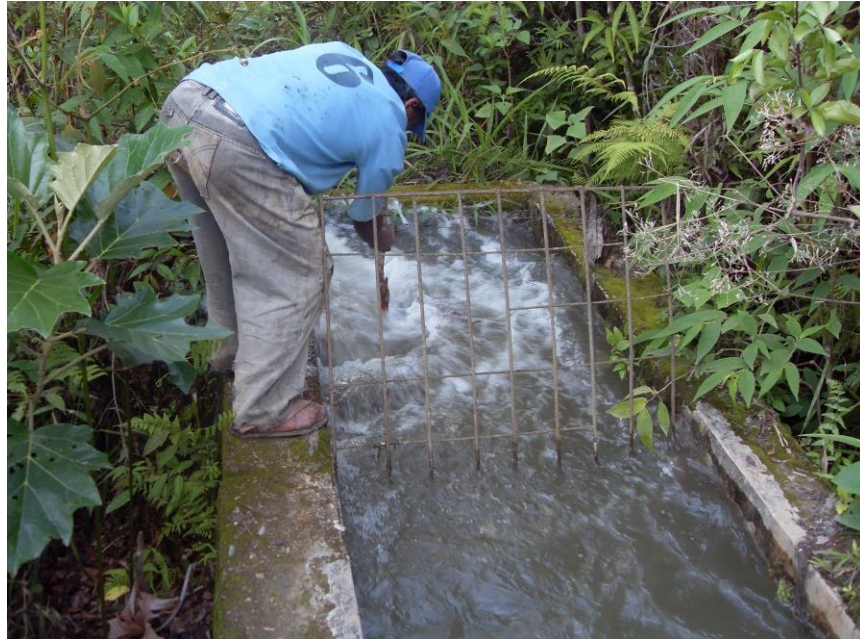
Foto: Cámara de carga (Santa Rosa de Quilo Quilo)
