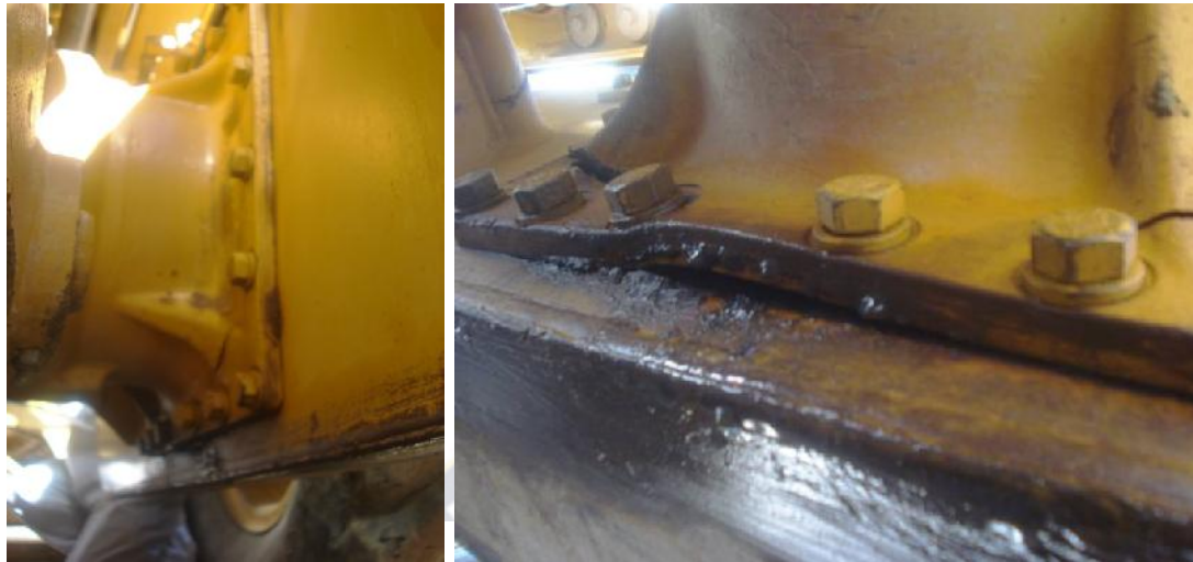
Soporte de eje de diferencial a tandem de ambos lados roto y doblado.
