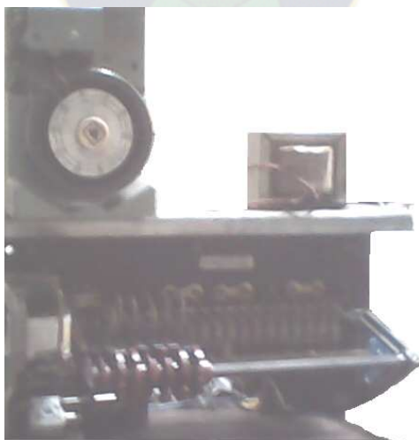
Fig. (3) Controlador electromecánico ref: GAML P
