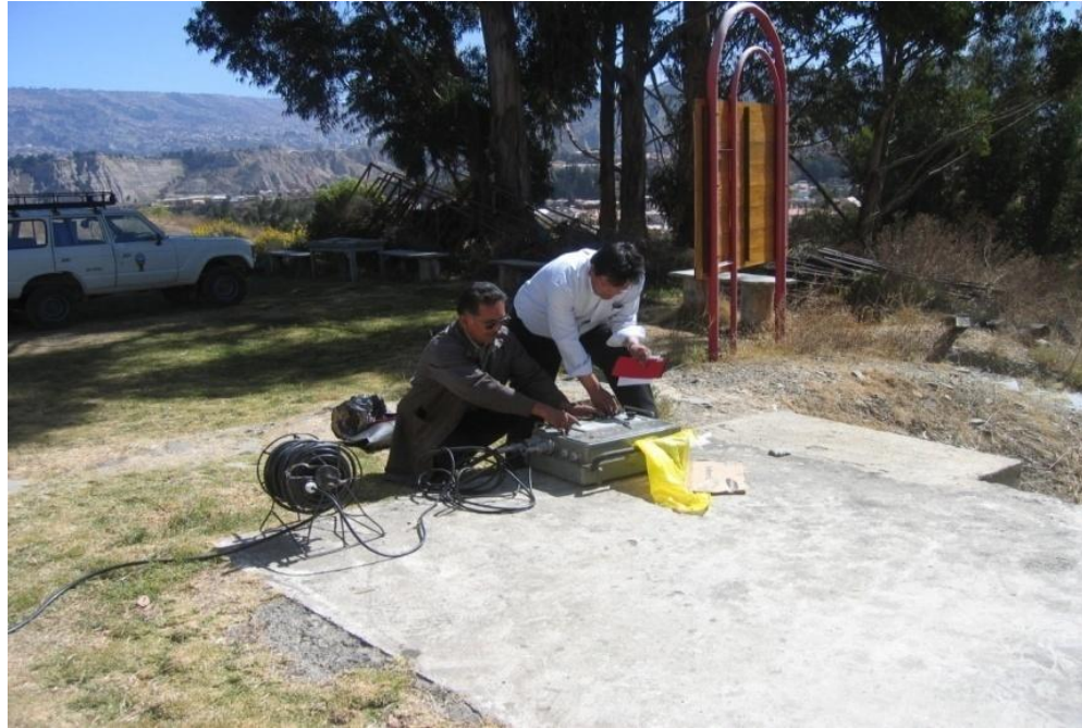
Figura 39: Control externo del panel de mando situado a 10 metros de distancia del Equipo de rayos x. (Fuente Propia)
