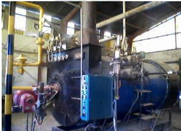
Figura 3. Caldera pirotubular de ILLAMPU TEXTIL S.R.L.
