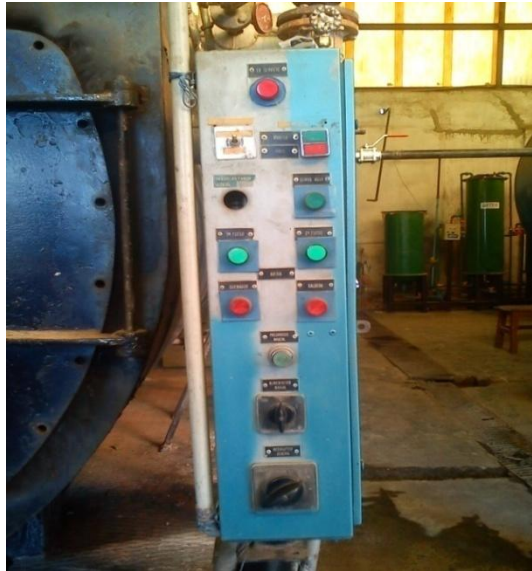
Figura 24. Tablero de control de la caldera, ILLAMPU TEXTIL S.R.L.
