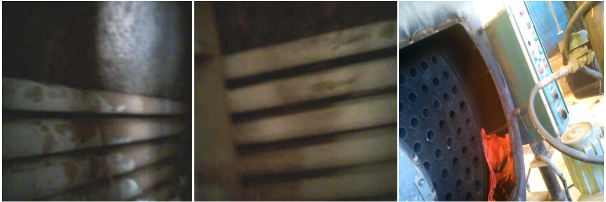
Figura 35. Tubos de la caldera pirotubular, ILLAMPU TEXTIL S.R.L.
