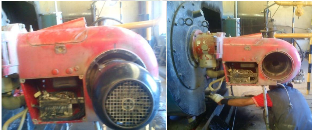
Figura 45. Realizando el mantenimiento del Quemador, ILLAMPU TEXTIL S.R.L.
