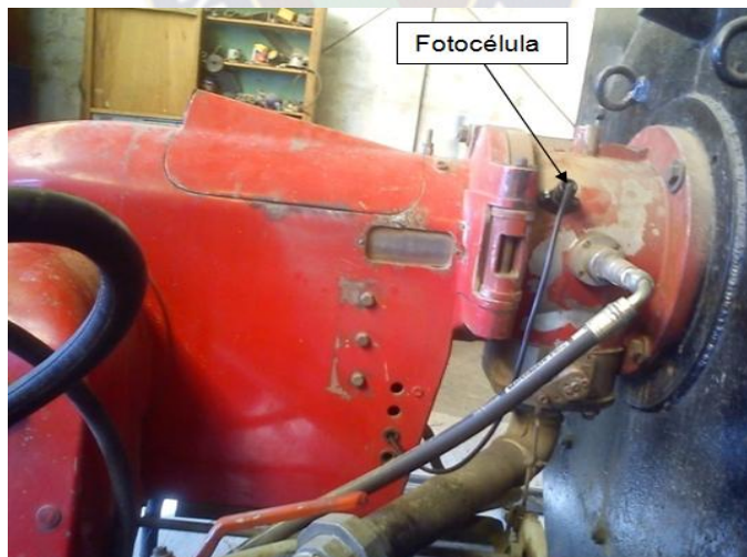
Figura 47. Fococélula del Quemador de la caldera, ILLAMPU TEXTIL S.R.L.
