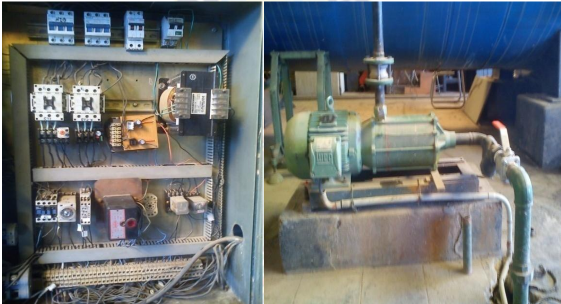
Figura 23. Interruptores del tablero y la bomba de agua, ILLAMPU TEXTIL S.R.L.
