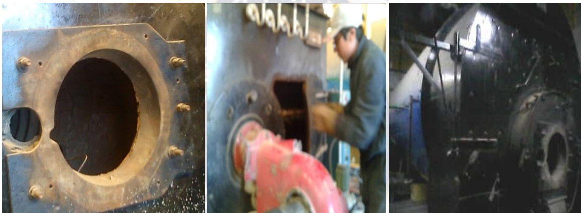
Figura 32. Refractario cónico, Miguel Sonco Pasante, caldera pirotubular, ILLAMPU TEXTIL S.R.L.
