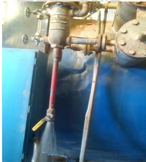
Figura 29. Lodos, corrosión, e incrustación que se pueden formar por mal tratamiento del agua en los controles de nivel. Debe ser eliminado por el proceso de purgado, ILLAMPU TEXTIL S.R.L.
