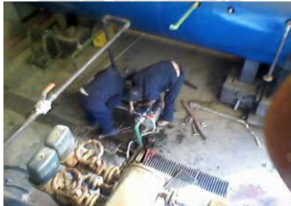
Figura 26. Personal realizando el mantenimiento de la Bomba de agua, ILLAMPU TEXTIL S.R.L.
