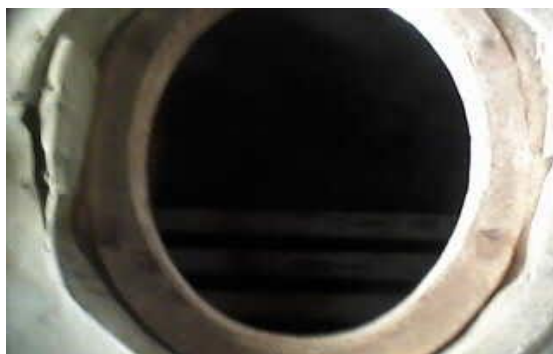
Figura 30. Vista de arriba el estado de los tubos de la caldera, ILLAMPU TEXTIL S.R.L.
