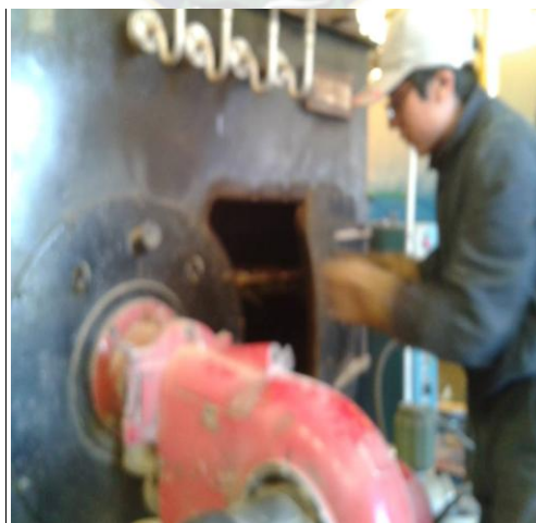
Figura 7. Miguel Sonco Pasante abriendo la puerta de la Caldera pirotubular de ILLAMPU TEXTIL S.R.L.
