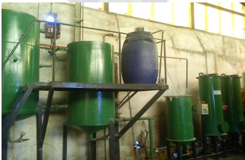
Figura 19. Tratamiento del agua de la caldera, ILLAMPU TEXTIL S.R.L.
