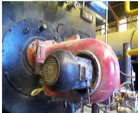
Figura 4. Quemador de la Caldera de ILLAMPU TEXTIL S.R.L.
