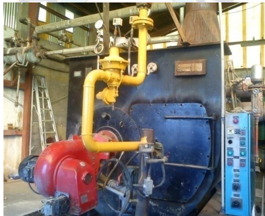
Figura 44. Quemador de la caldera pirotubular, ILLAMPU TEXTIL S.R.L.
