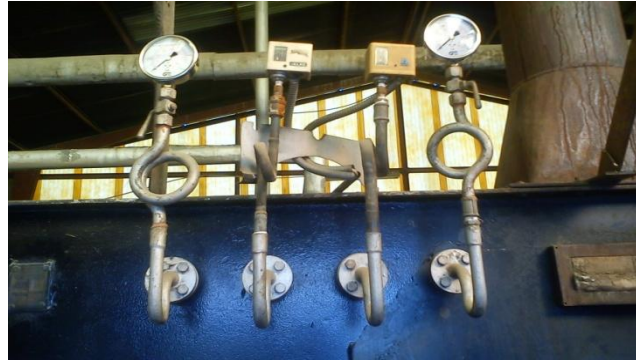
Figura 9. Manómetros que usa la caldera pirotubular de ILLAMPU TEXTIL S.R.L.
