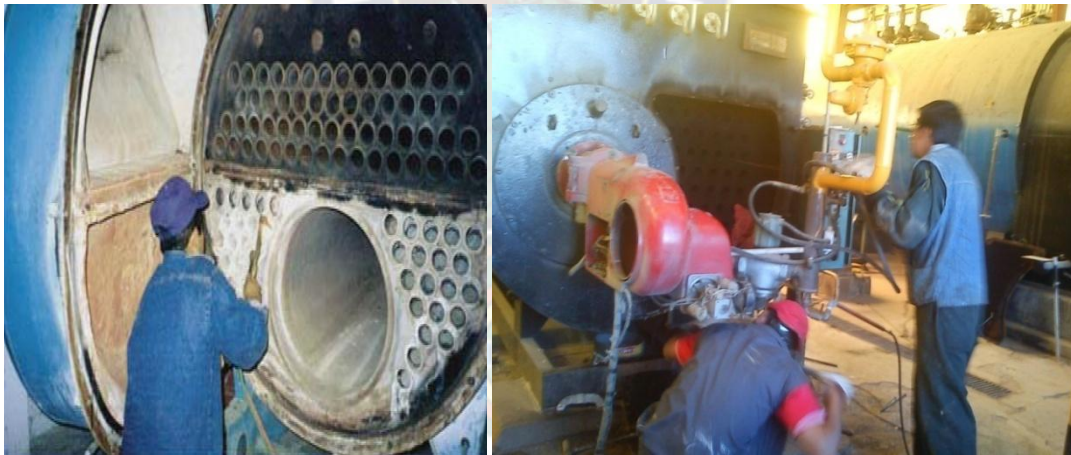
Figura 27. Personal realizando la limpieza de tubos, ILLAMPU TEXTIL S.R.L.
