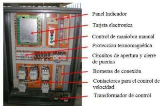
Figura 15. Tablero de control o cuadro de maniobra
