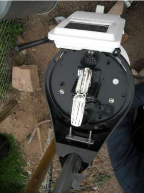
Pluviómetro de la estación
