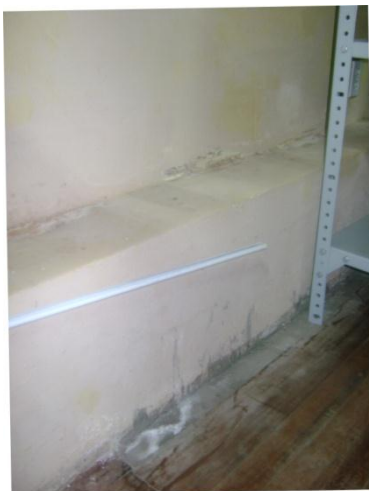
Humedad en el piso
