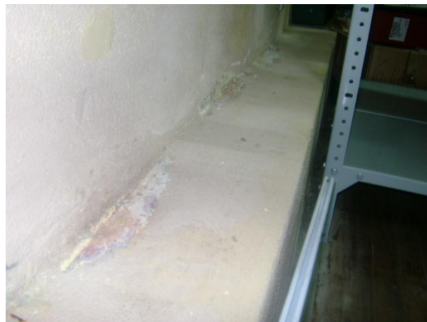
Humedad en las paredes
