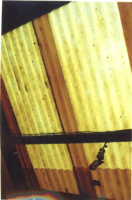
2. Espacio físico e iluminación inadecuados
