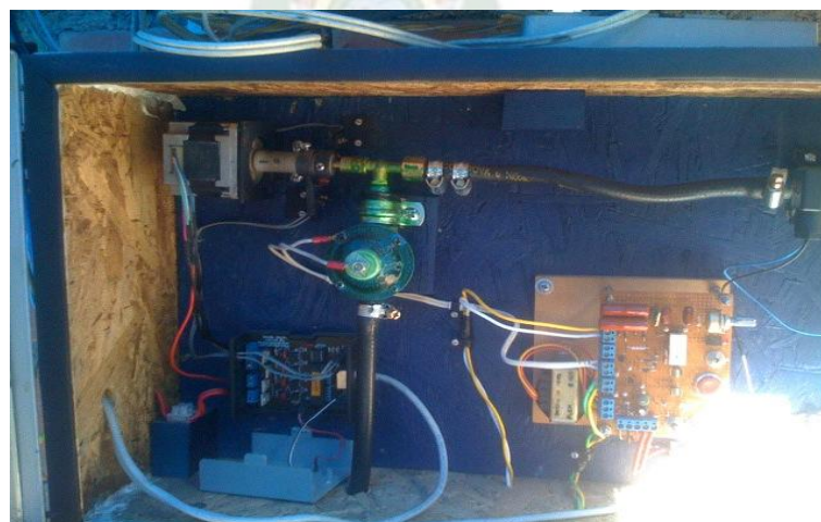
Figura 2.34: Tablero de control de apertura de Gas. Fuente: Scala Design S.R.L.
