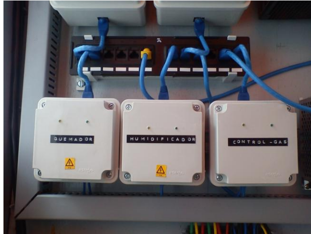
Figura 2.33: Periféricos de control de quemador, humidificador y control de gas. Fuente: Scala Design S.R.L.
