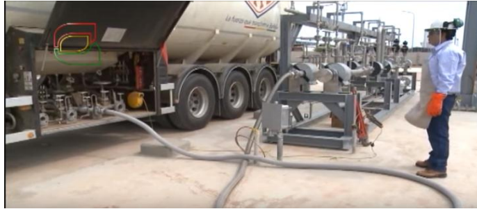
Figura 4.29 Sistema de cargado de GNL
