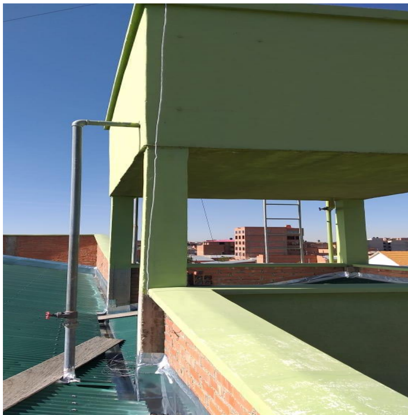
TANQUE DE AGUA DEL POLICLINICO DE VILLA ADELA
