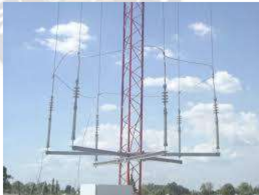
Figura 9: Torre Arriostrada, (Tipos de Torres para Telecomunicaciones)
