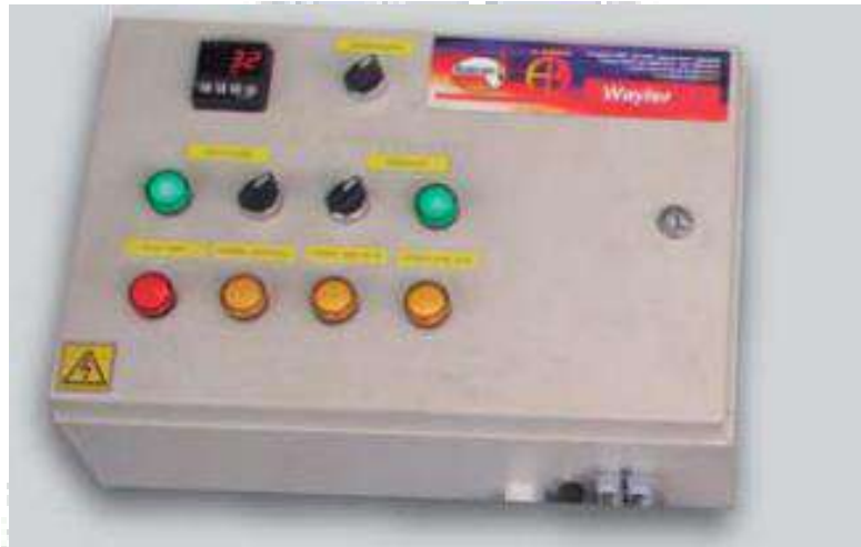
Figura: 28 Tablero eléctrico para controlar los quemadores
