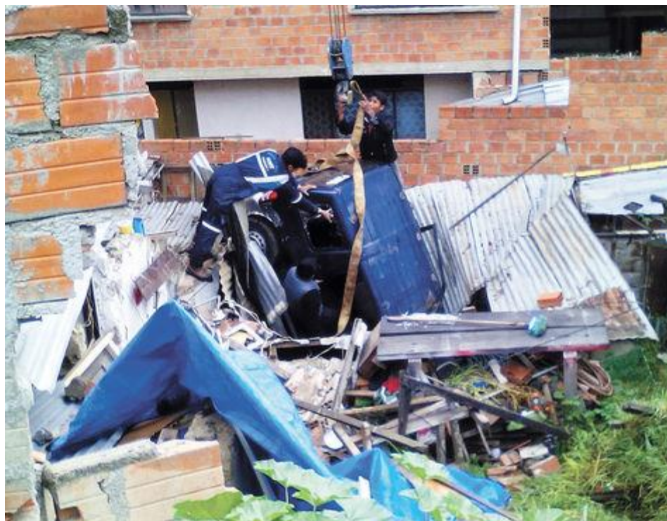
Destrozo. Foto proporcionada por los vecinos del primer intento de rescate del Mitsubishi, ayer. Miguel Carrasco.
