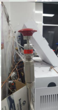
Figura N° 30. Válvula de alivio, instalada en el reactor como mecanismo de seguridad.
