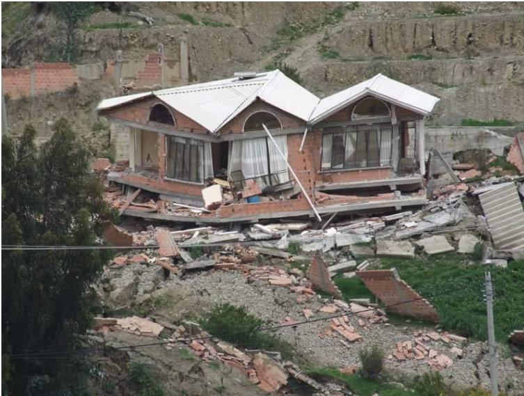
Casa de tres pisos afectada, unicamente planta alta se observa
