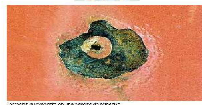
Figura: 4.31. Corrosión en el pintado
