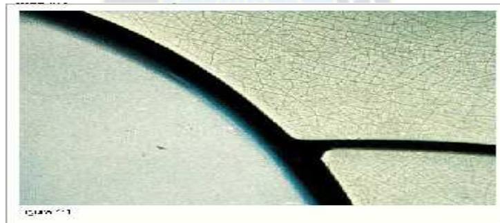
Figura: 4.25. Aparición de rajaduras en el pintado
