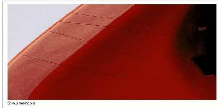
Figura. 4.24. Formación de grietas
