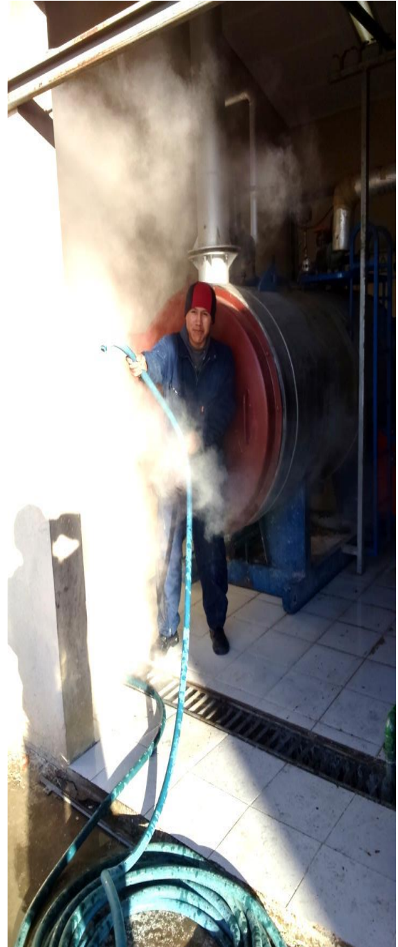
Fotografía 2 (Caldero de Vapor)
