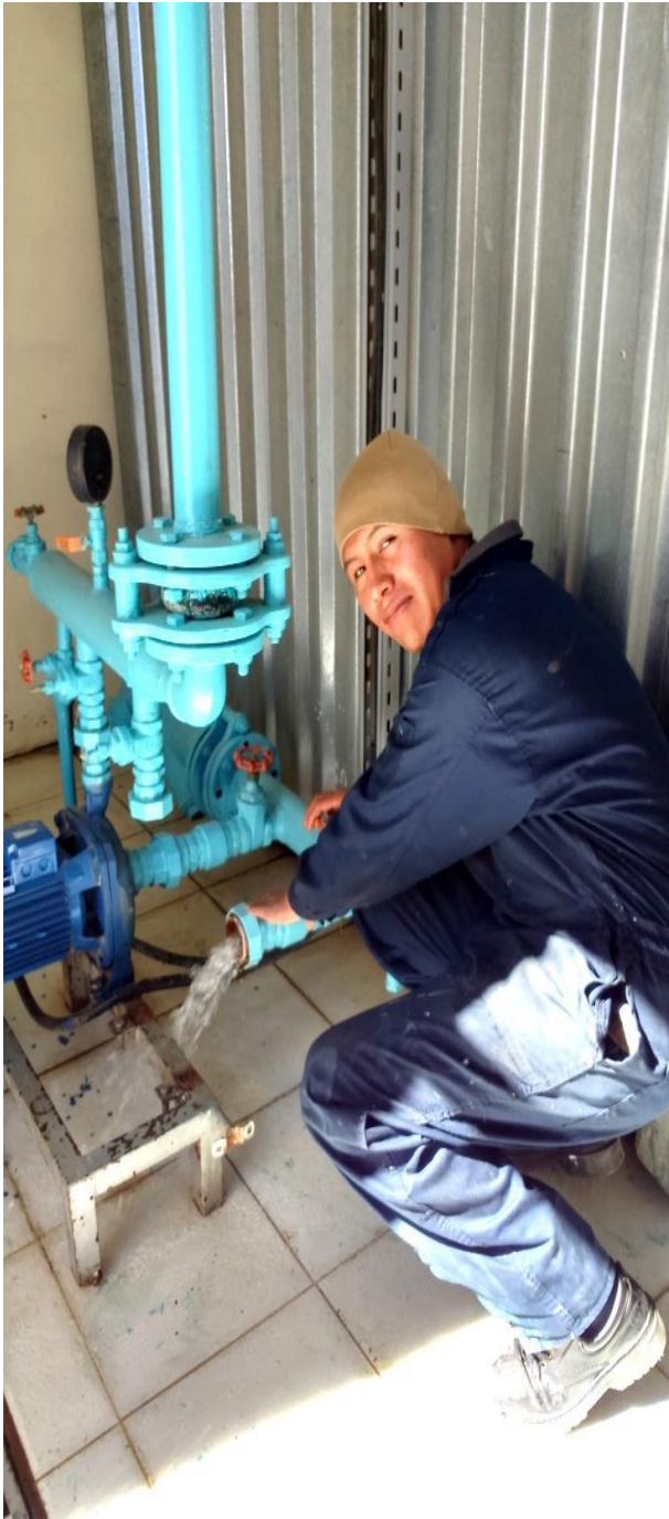
Fotografía 1 (Purgado de Agua de Banco de Hielo)
