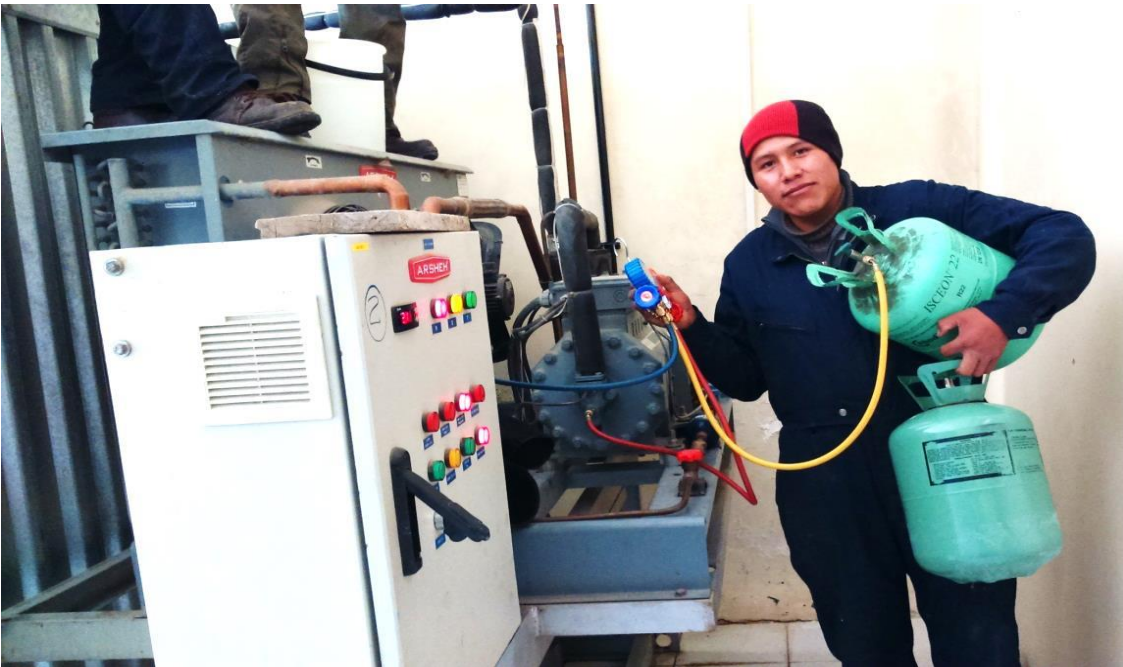
Fotografía 8 (Cargado de Gas Refrigerante de R-22)
