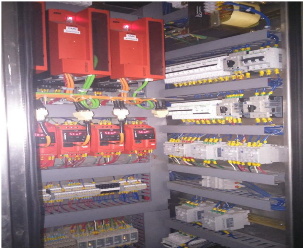
Fotografía 4 (Tablero Eléctrico de la Cámara Séptica)
