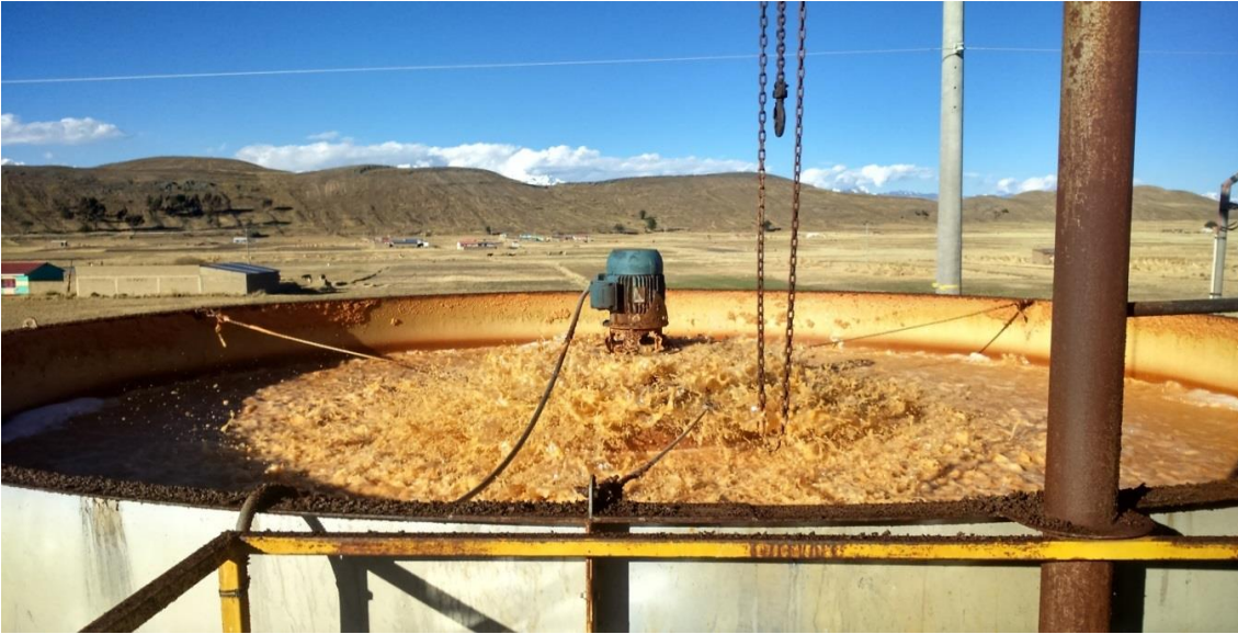
Fotografía 5 (Fosa de Tratamiento de agua)
