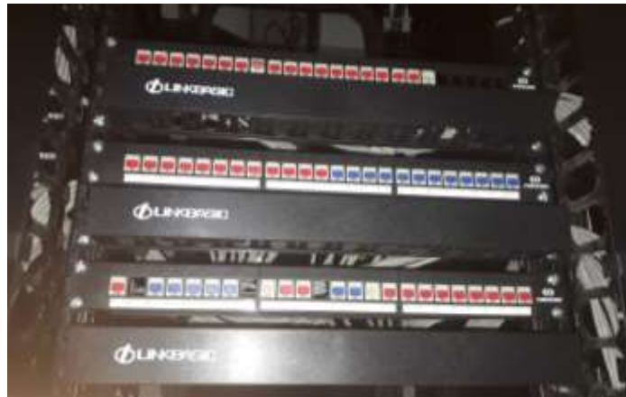
Figura: 16 Patch Panel de 24 puertos Fuente: Elaboración Propia
