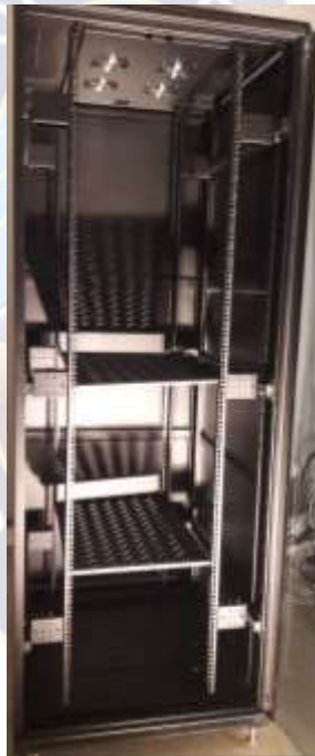
Figura: 12 Gabinete o Rack Fuente: Elaboración Propia
