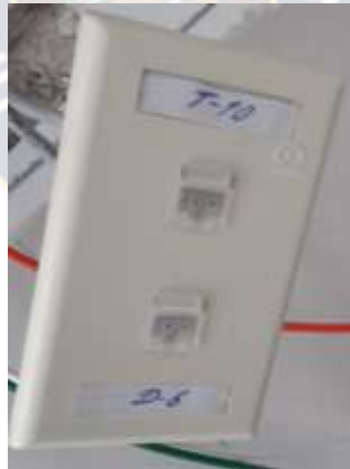
Figura: 11 Faceplate ubicados en punto de trabajo Fuente: Elaboración Propia
