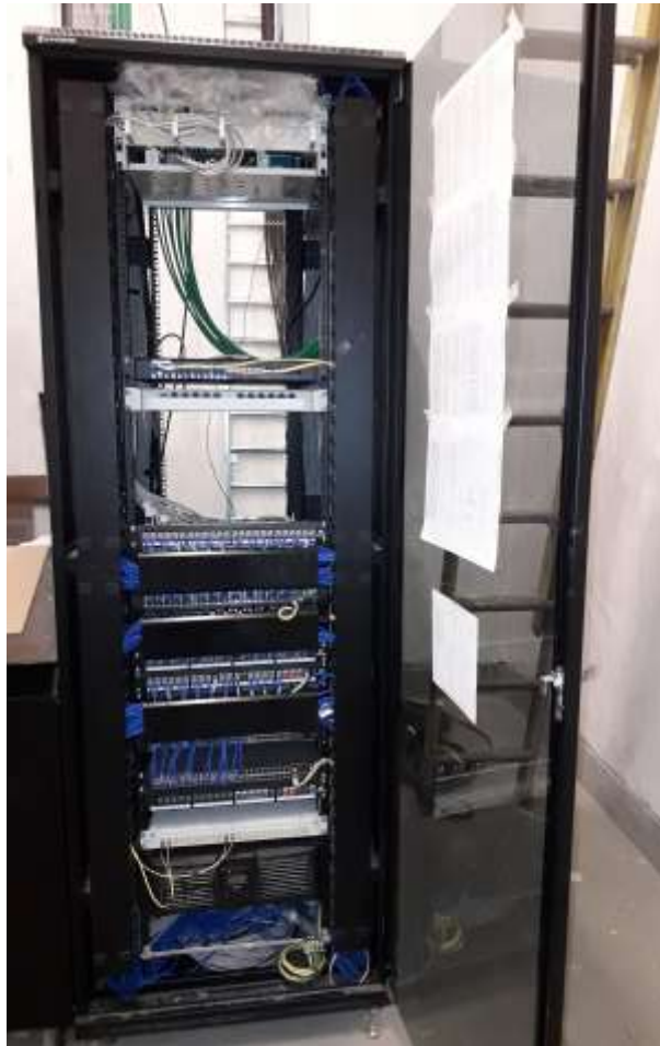
Figura: 15 Organizador vertical, armado en Rack Fuente: Elaboración Propia
