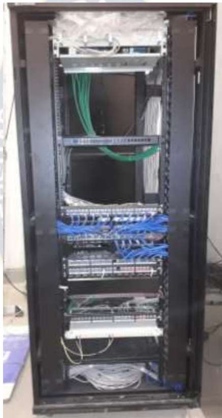
Figura: 20 Rack Fuente: Elaboración Propia
