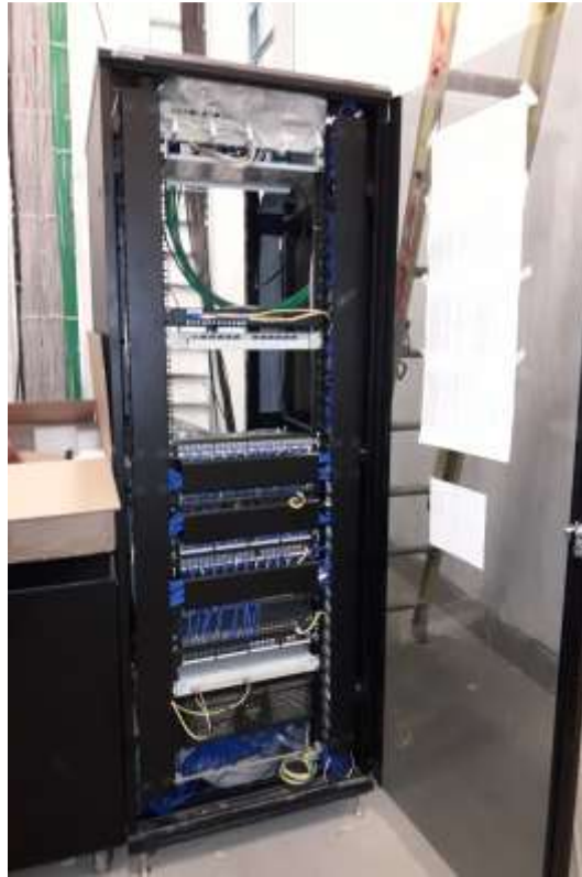
Figura: 26 Ubicación de Rack en cuarto de Telecomunicaciones
