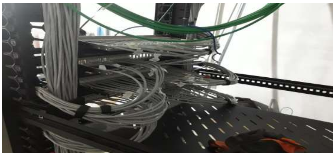
Figura: 18 Conexión a Patch Panel
