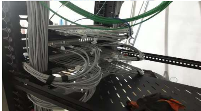
Figura: 34 Peinado de Rack en Patch Panel Fuente: Elaboración Propia
