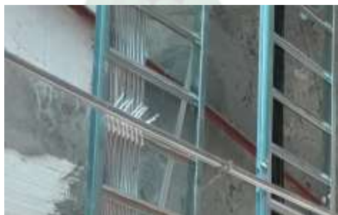
Figura: 8 Bandejas Metálicas Para Cableado Fuente: Elaboración propia
