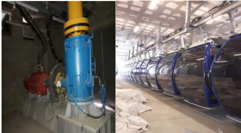
Figura: 29 Ducto EMT en parquin y área de motor (lugares visibles) Fuente: Elaboración Propia
