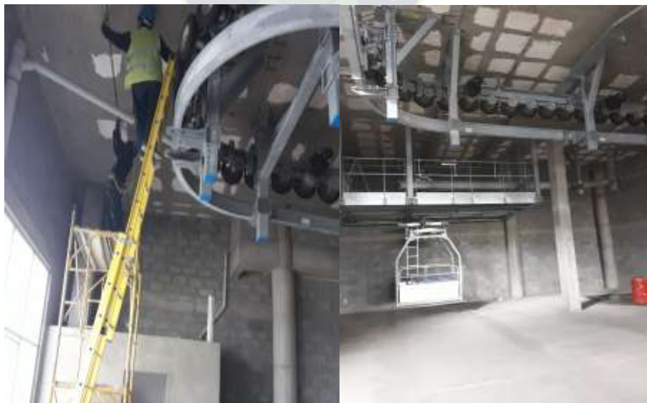
Figura: 28 Ducto EMT en Parquin en estación Rio Seco Ex Tranca en lugares visibles Fuente: Elaboración Propia
