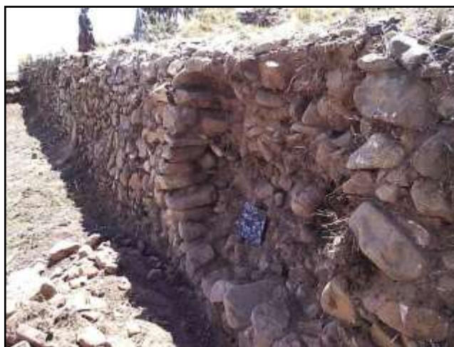
Fotografía 8. Muro deteriorado (Plaza V. 2010)
