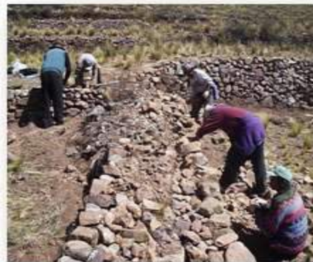
fotografía 16. Construcción de terrazas, cuando se dispone de piedras pequeñas, para mayor resistencia
