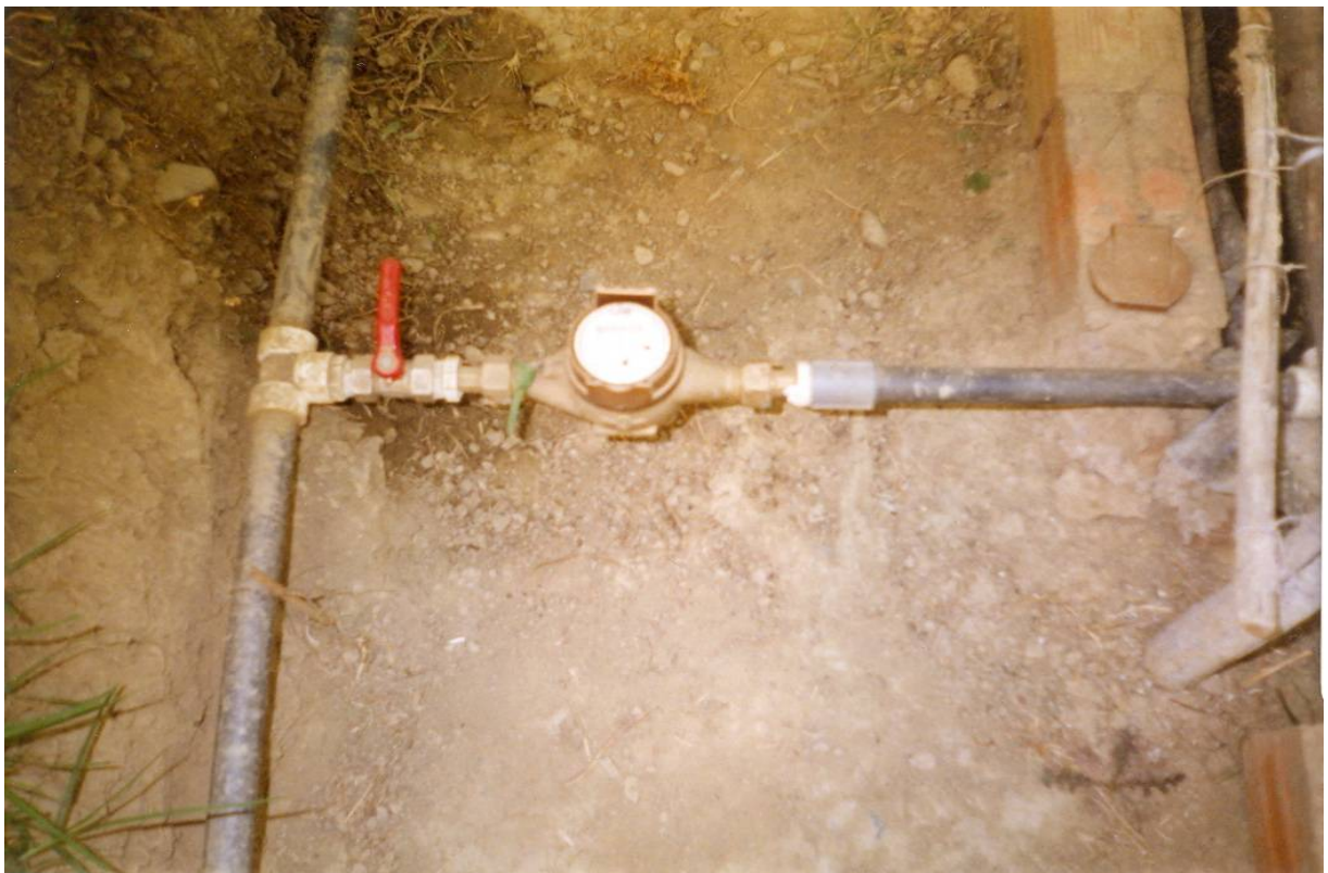
FOTO 10. Vista parcial del sistema de riego: línea principal – válvula - flujómetro
