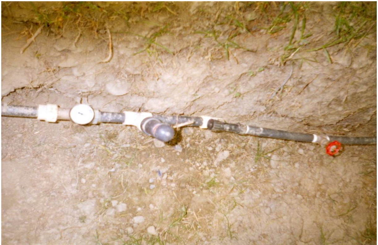
FOTO 9. Cabezal del sistema de riego: válvula – filtro – extractor de aire - manómetro
