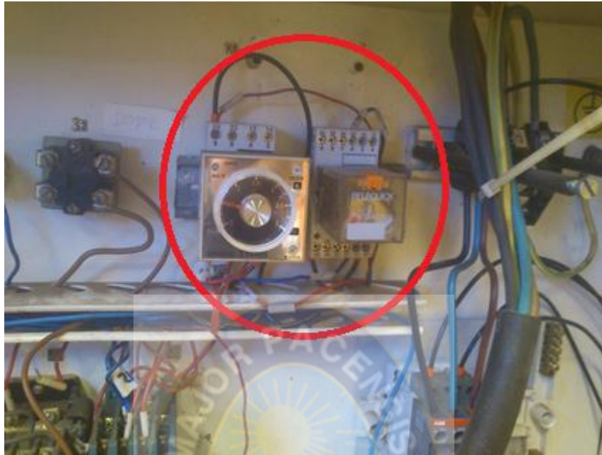
Figura 3. 14 Relé inductivo y relé temporizador implementados
