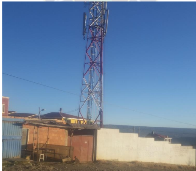
Figura 31: Fotografía Exterior de Rbs. Los Rosales Entel
