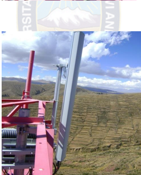
Figura 36. Antena sector 3 (fuente Entel)
