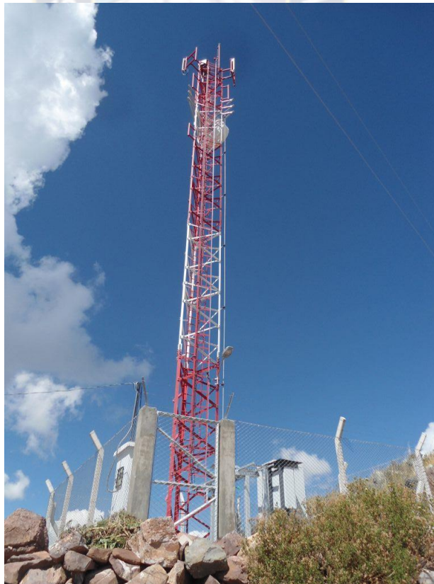
Figura 20. Torre autosoportada GSM (fuente propia)
