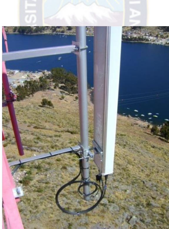
Figura 35. Antena sector 1 (fuente Entel)
