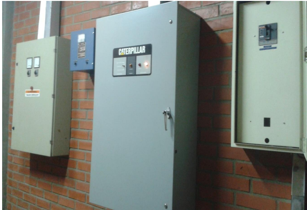
Figura 3.13: Gabinete de Control de Grupo electrógeno del Rosario Fuente: Fotografía Propia
