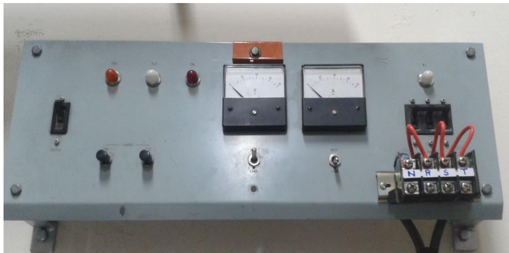
Figura 3.14: Sistema de Control. Fuente: Fotografía Propia
