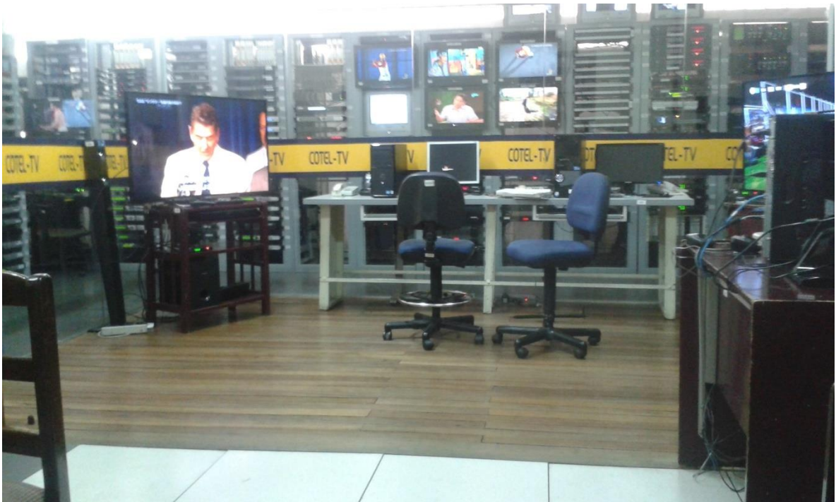
Figura 3.4: Sala de Control y Monitoreo de la Cabecera de Cotel Tv. Fuente: Fotografía Propia
