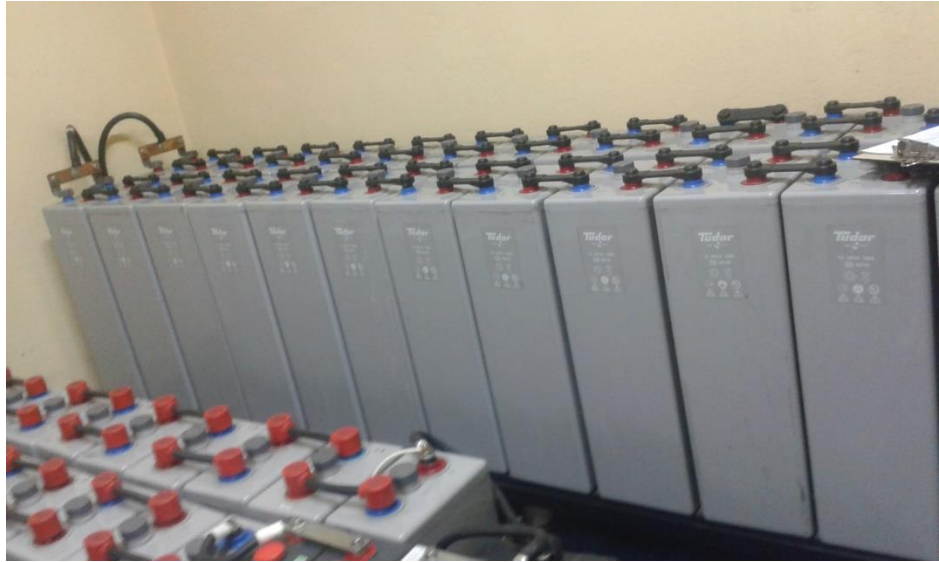
Figura 3.12: Banco de Baterías (Burgaleta). Fuente: Fotografía Propia
