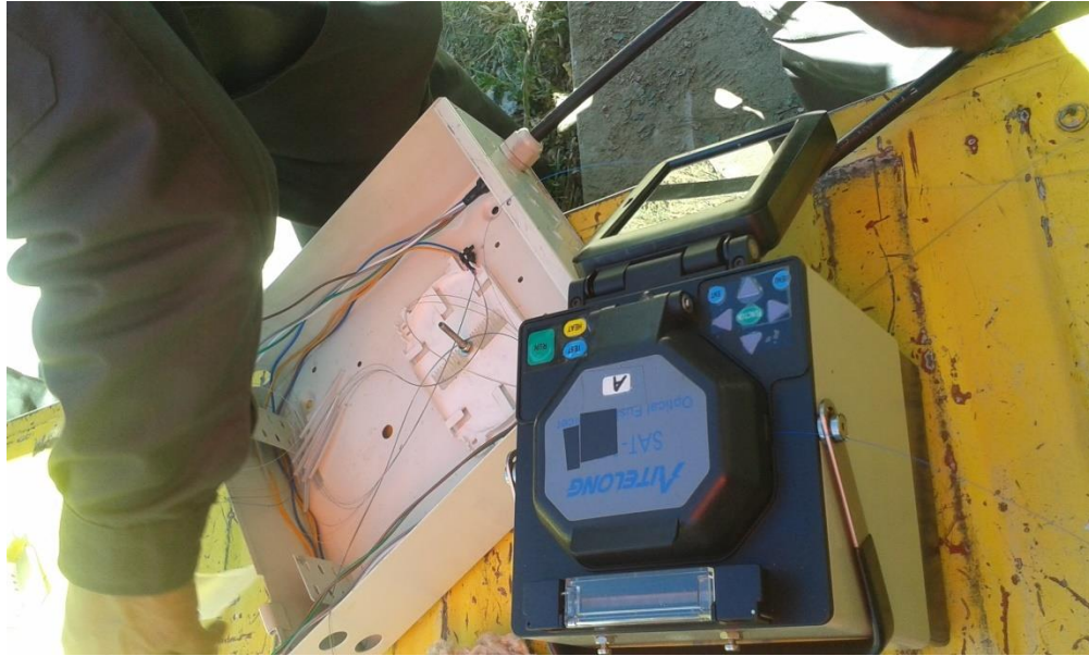
Figura 3.10: Ampliación de la red óptica de Wajchilla. Fuente: Fotografía Propia
