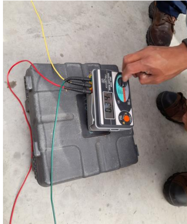
Figura 33. Medición de la Resistencia Fuente: [Elaboración Propia]
