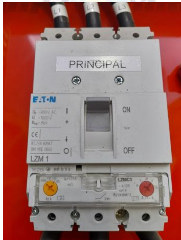
Figura 24 Interruptor térmico de la planta. Fuente: [Elaboración Propia].
