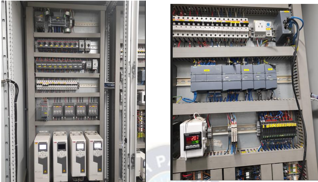
Figura 18. Tablero Planta de tratamiento de Aguas Fuente [Elaboración Propia]
