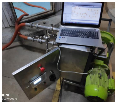
Figura 4.19 Verificación del funcionamiento del algoritmo en el PLC en el computador.
