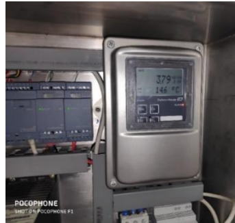
Figura 4.13 Controlador del sensor de conductividad en funcionamiento.
