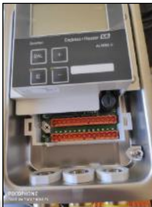
Figura 4.10 Pines de conexión del controlador del sensor de conductividad al descubierto.
