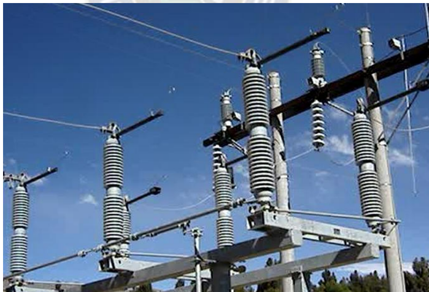
Fig. 13. Seccionador de Enclavamiento Clase 161kV en barra 69kV.
