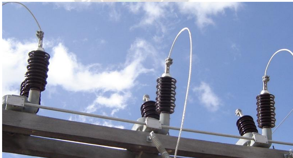
Fig. 10. Transformadores de Potencial instalados en la bahía de 24,9kV.
