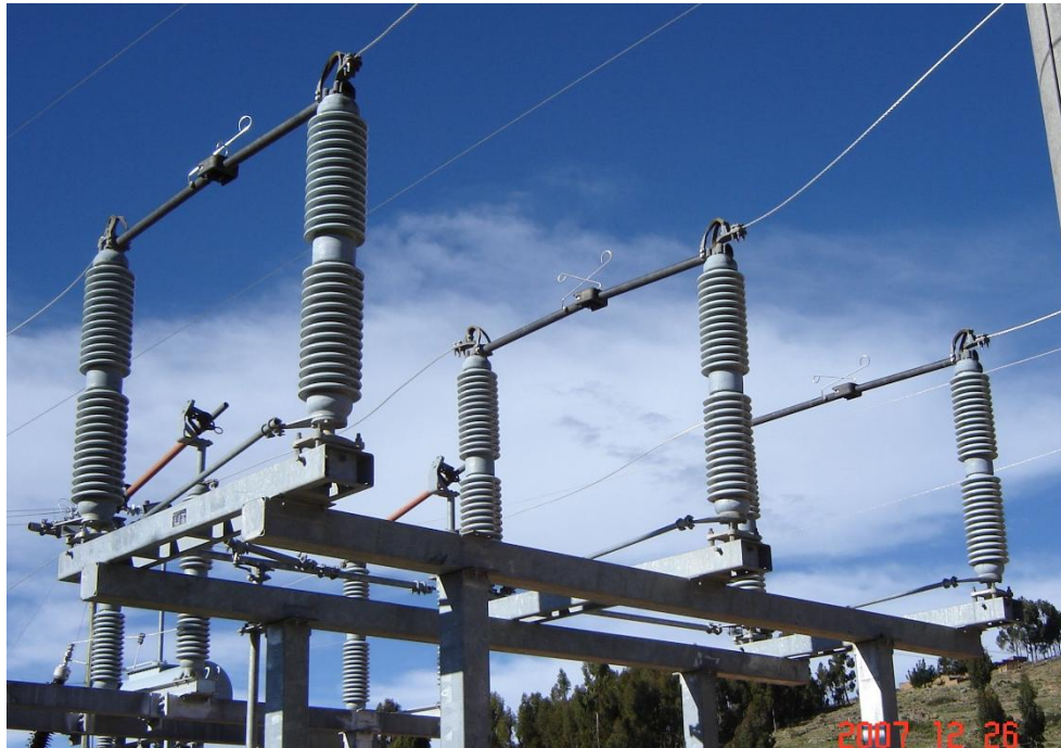
Fig. 19. Calibrado del seccionador de enclavamiento, donde se observa contacto uniforme en los polos en el cierre definitivo.
