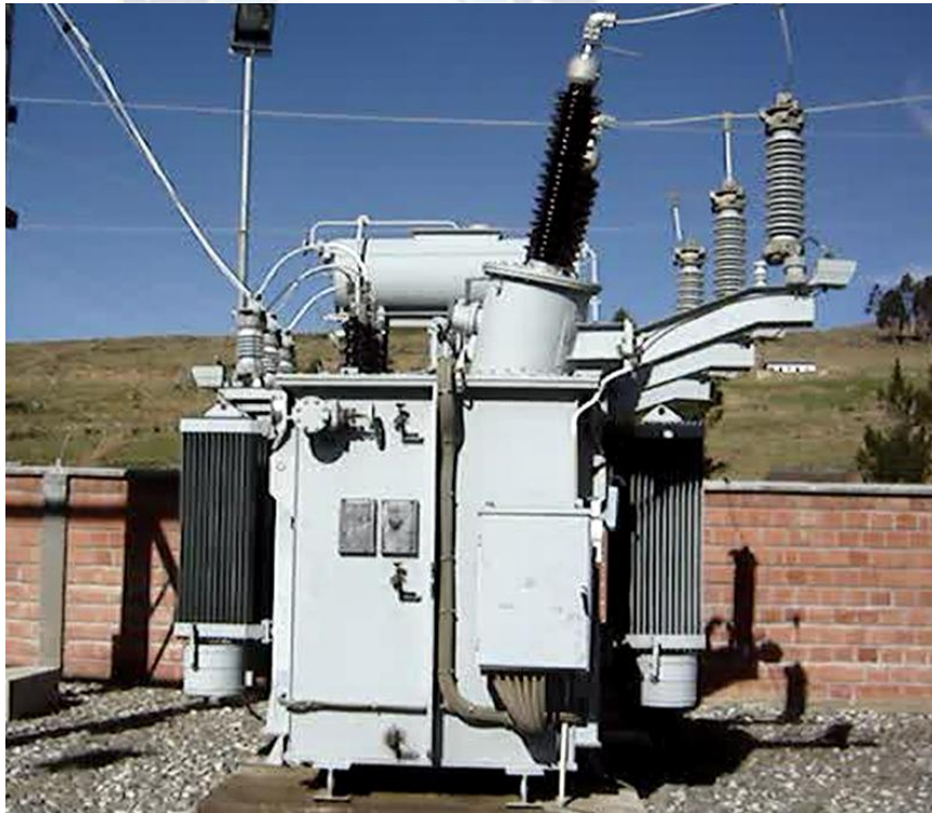
Fig. 8. Transformador de potencia 4/5,2MVA – 69/24,9kV Subestación Chaguaya.
