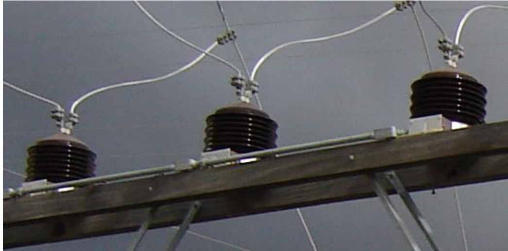
Fig. 9. Transformadores de Corriente instalado en la bahía de 24,9kV.
