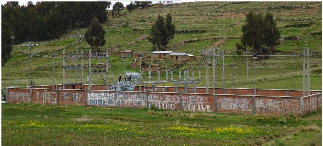
Fig. 2. Vista exterior de la Subestación Chaguaya
