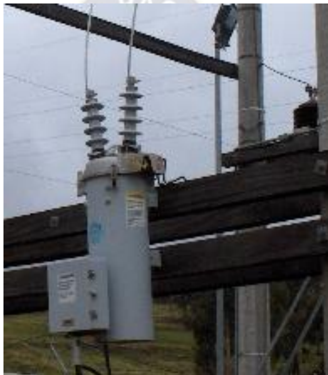
Fig. 14. Reconectador monofásico, protección de cabecera Alimentador Puerto Acosta instalados en la bahía de 24,9kV.
