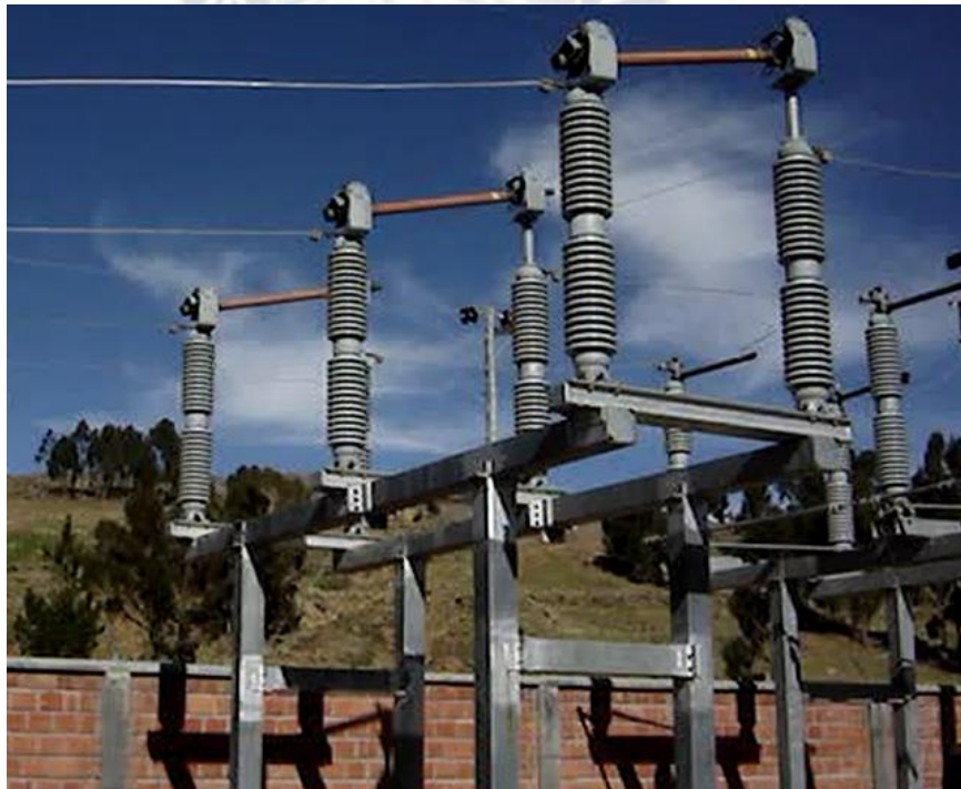
Fig. 12. Seccionador-Fusible de Potencia Clase 115kV en barra 69kV.
