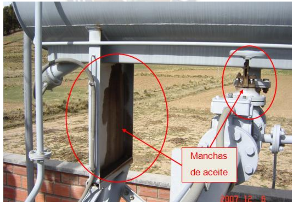
Fig. 22. Mancha de aceite en el soporte del tanque de expansión y válvula del relé buchholz del transformador de potencia.
