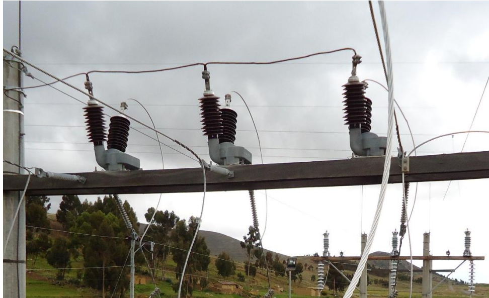
Fig. 24. Ejecutado el cierre de los puentes de los transformadores de potencial (PT's) y su conexión a tierra, instalados en la bahía de 24,9kV
