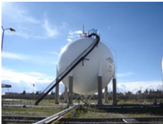
Fuente: Área de almacenamiento de GLP
