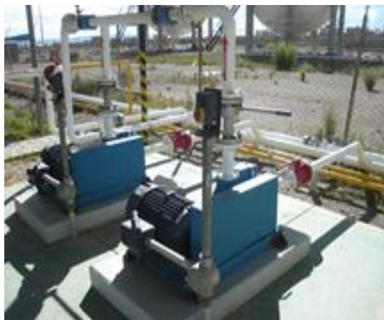
Figura 6: Bombas y compresores
