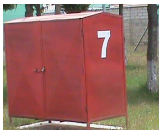
Figura 13: Gabinete de mangueras
