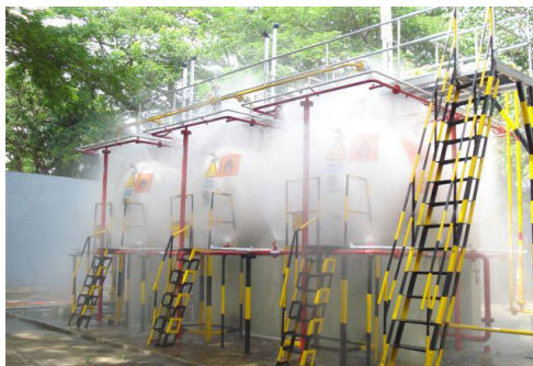
Figura 18: Tanques horizontales de GLP con un sistema de aspersión con 100% de cobertura
