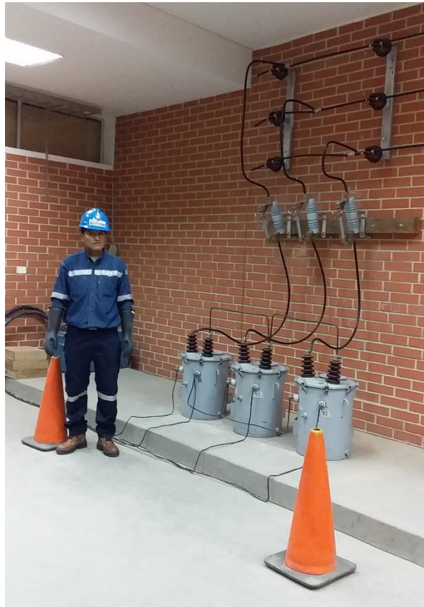
CONEXIÓN PARA ELEVAR EL VOLTAJE DE 380 A 12000 VOLTIOS CON UN BANCO DE TRANSFORMADORES MONOFASICOS
