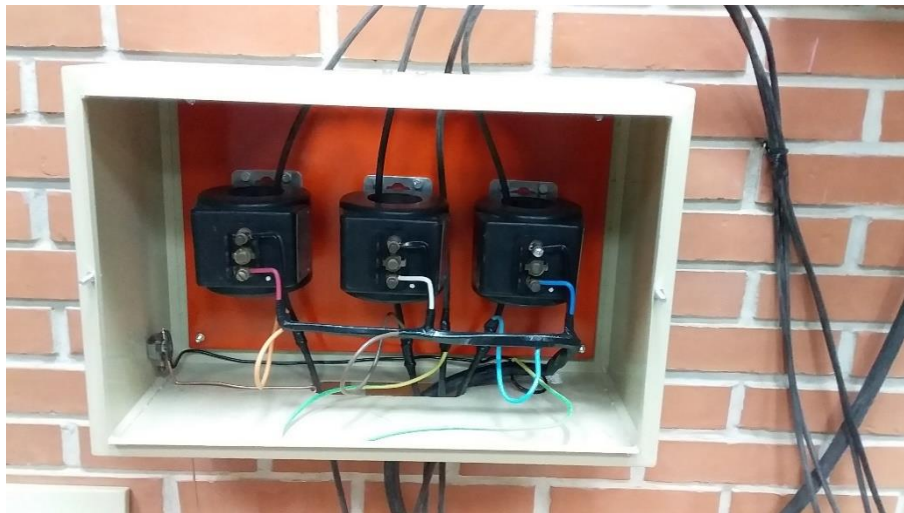
CONEXIÓN DE LOS TRANSFORMADORES DE CORRIENTE
