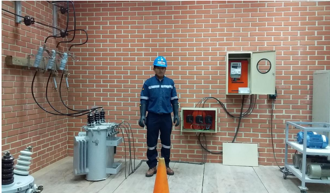
EQUIPO DE MEDICIÓN INSTALADO EN EL CENTRO DE TRANSFORMACIÓN
