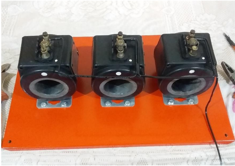
TRANSFORMADORES DE CORRIENTE DE 200/5 CON CONEXIÓN ESTRELLA.
