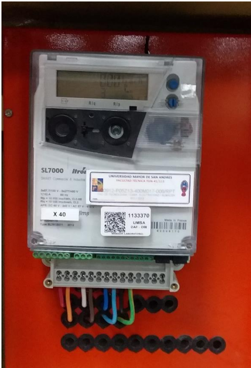
CONEXIÓN DEL MEDIDOR ITRON SL7000 Y DESPLIEGUE DE DATOS
