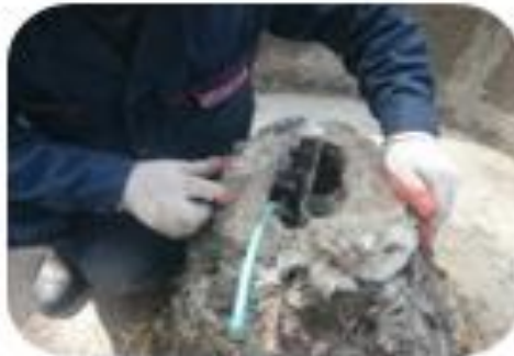
Sistema de Bombeo de Agua Deteriorado
