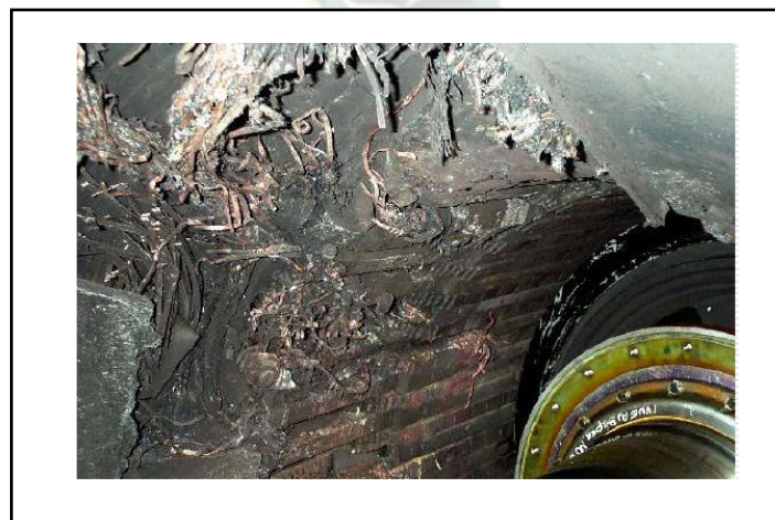
Figura 2.10 falla fase - fase Fuente: www analisis motor eléctrico.com .
