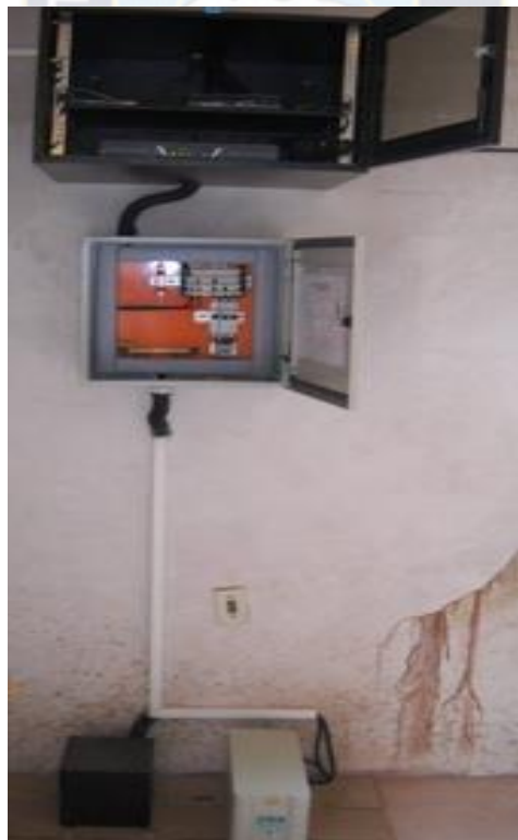
Figura 42. Imagen de la instalación interna. Rack, tablero de energía Transformador, UPS y el peinado del cableado.
