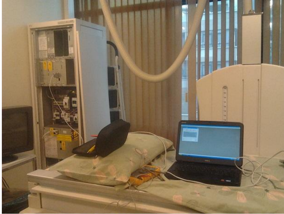
fig. 2.21 Comunicación con el Generador
