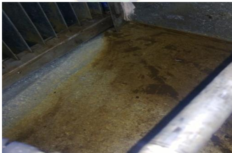
FOTO 12 PISCINA DE AGUA
