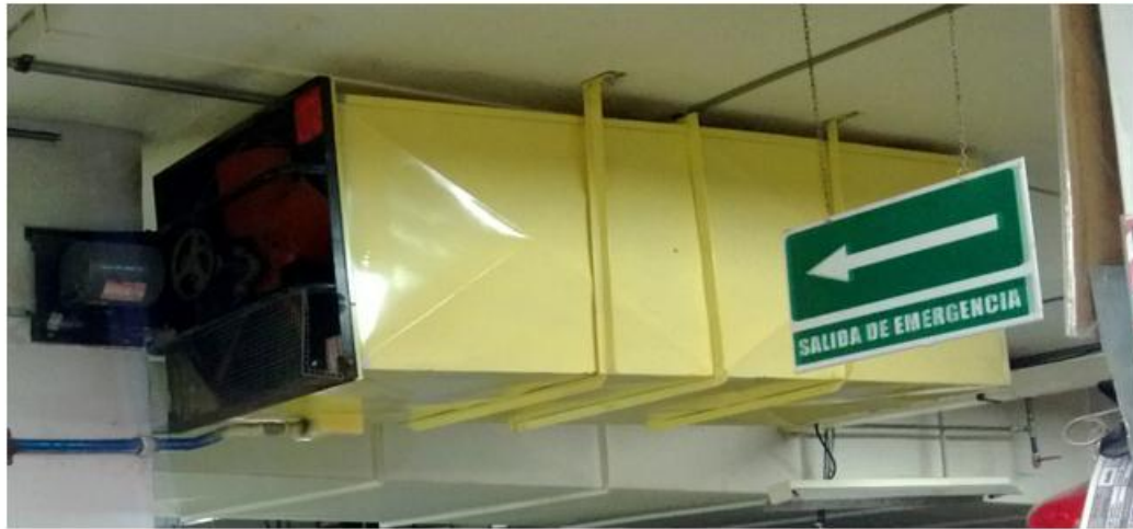
FOTO 2 DUCTO DEL SISTEMA HUMIDIFICADOR REDISEÑADO
