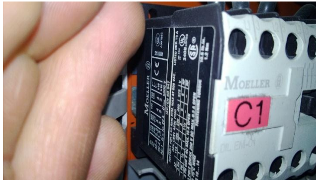
FOTO 18 CONTACTORES DAÑADOS DEL TABLERO DE LUCES DE SALA DE CONFECCIÓN
