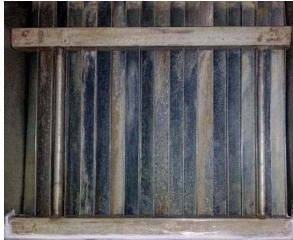
FOTO 3 SEPARADOR O FILTRO DE GOTAS
