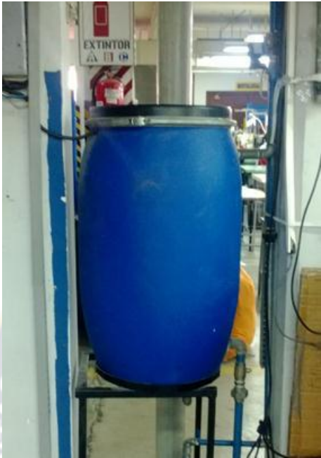
FOTO 11 ESTANQUE DE AGUA
