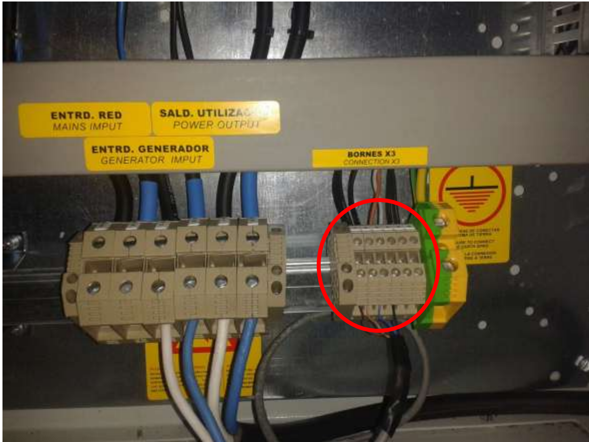
Figura 3.3 Borneras de conexión para el grupo generador HYMOINSA.
