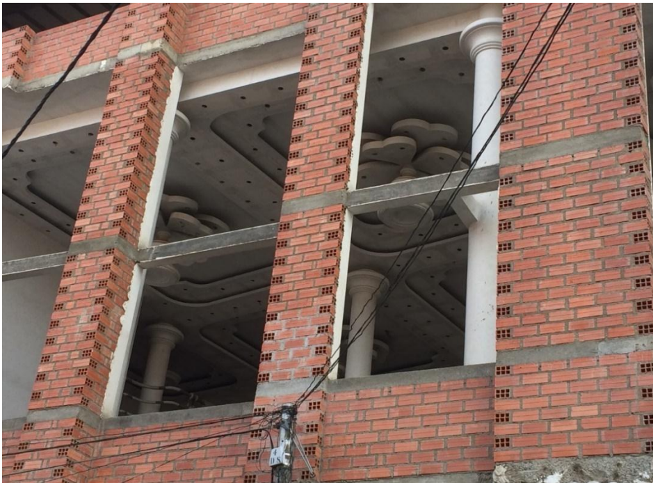
Ilustración 7. Sin nombre, edificio en construcción en la av. Juan Pablo II. Fuente: archivo personal.
